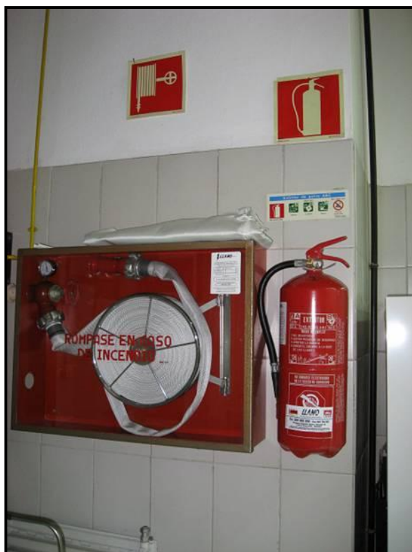
Figura 5.12: Extintores y mangueras contra incendio.
