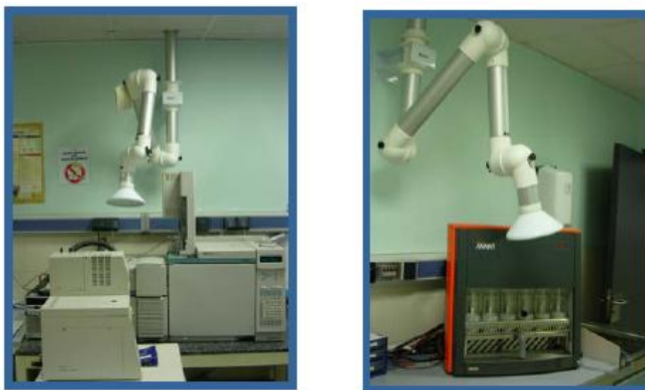
Figura 5.9: Campanas extractoras localizadas.
