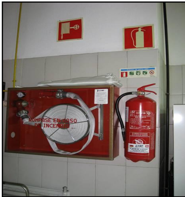
Figura 4.19: Extintores y mangueras contra incendio.
