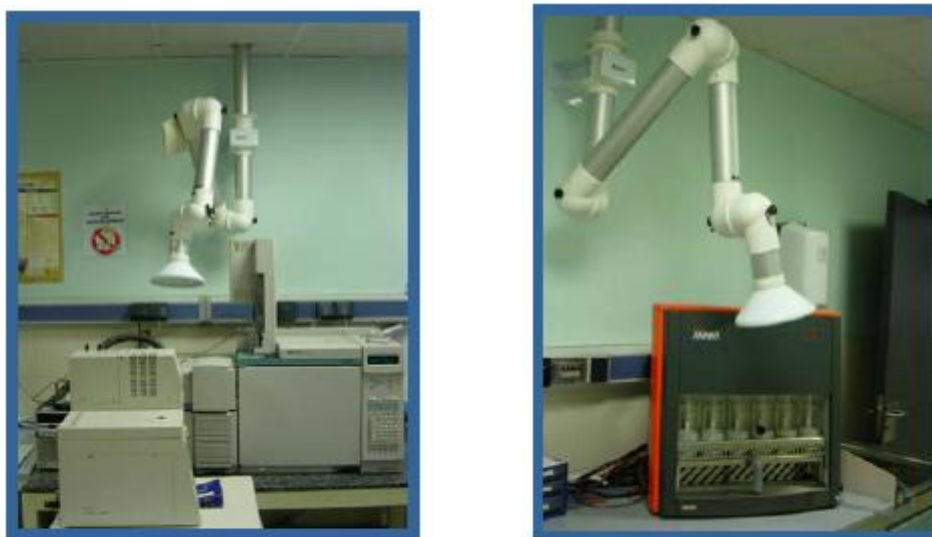
Figura 4.16: Campanas extractoras localizadas.
