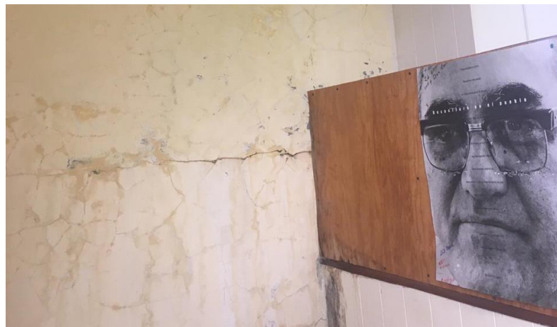
Figura 5.13. Grieta ubicada en pared del tercer nivel, departamento de sociales.
