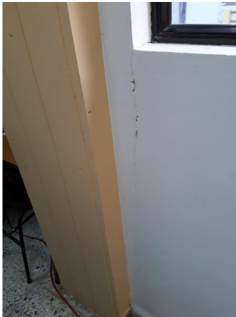
Figura 5.15 .Fisura en pared, costado poniente, Primer nivel, Biblioteca.
