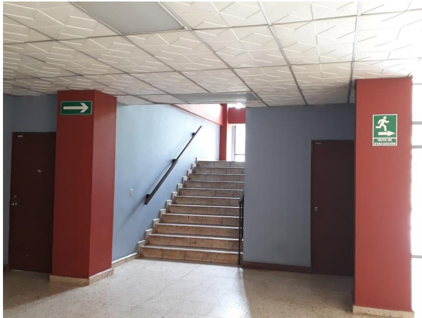
Figura 6. 6. Señalización de ruta de evacuación.
