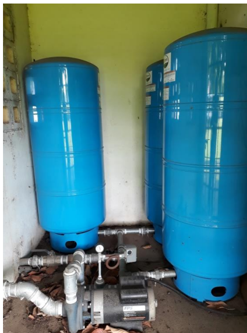
Figura 6. 1. Sistema de abastecimiento de agua, bomba achicadora.
