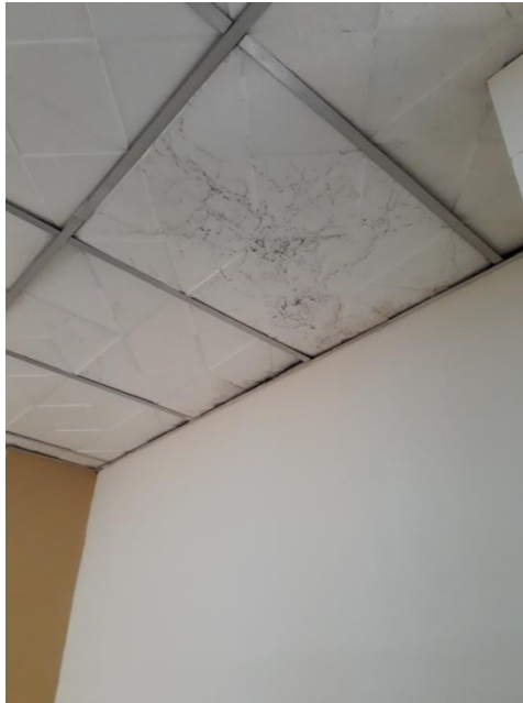
Figura 6. 2. Filtración del agua lluvia por juntas con falta de sello.
