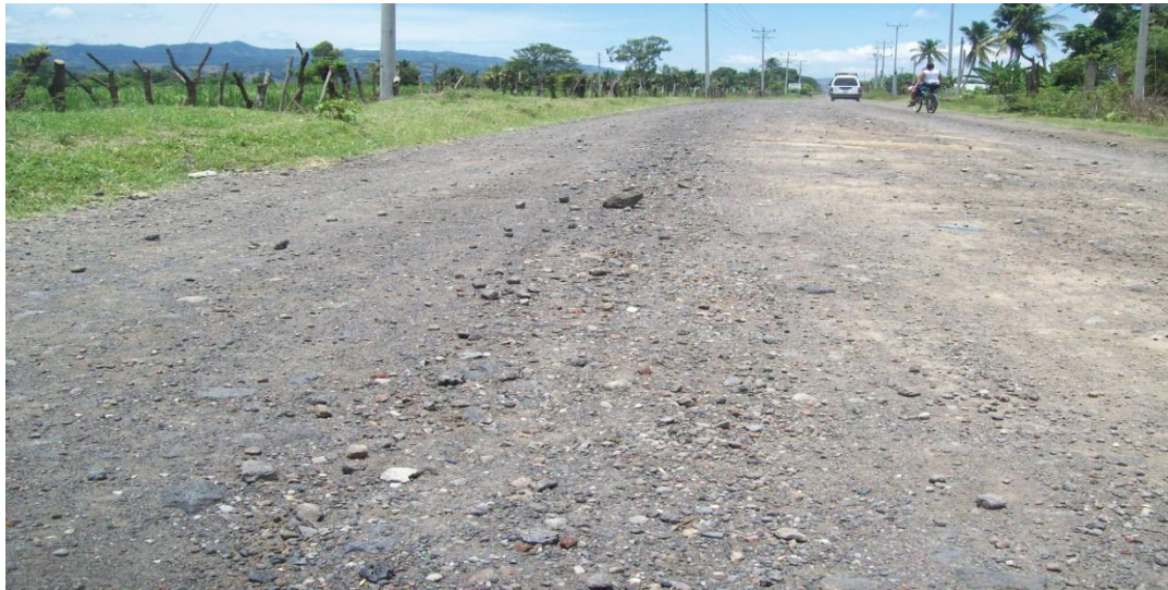
FIGURA 6.9 FOTO DE PERDIDA DE AGREGADO.
