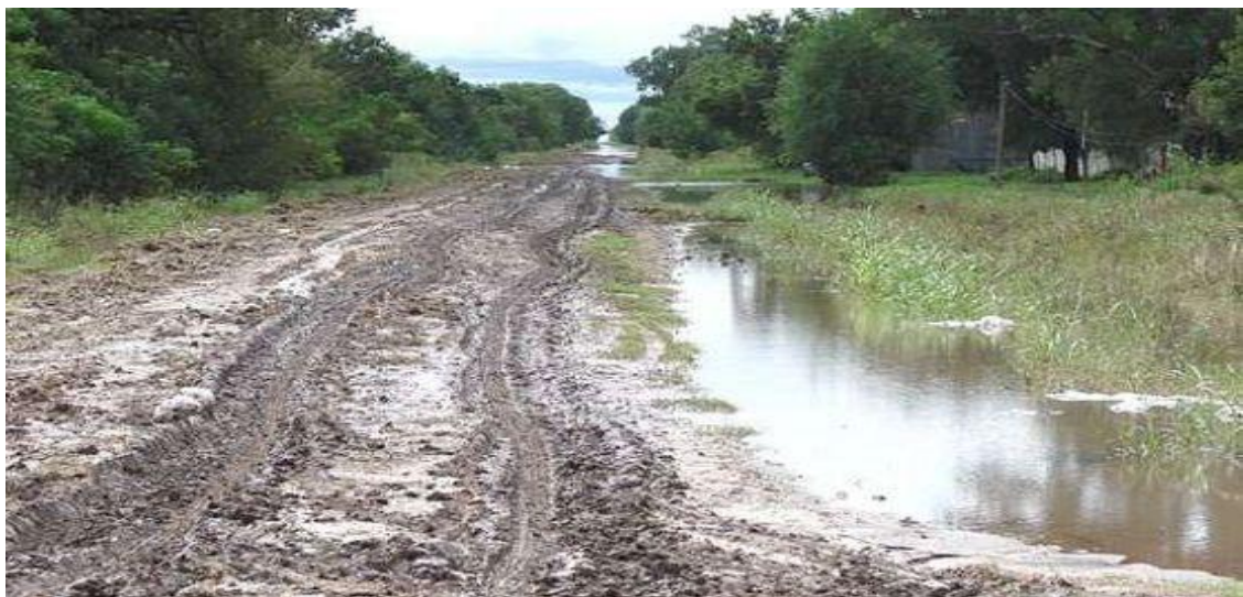
FIGURA 6.3 FOTO DE SECCION TRANSVERSAL INADECUADA.
