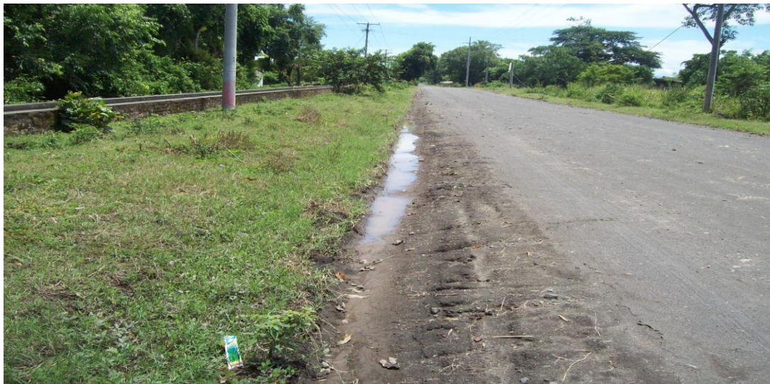
FIGURA 6. 13 FOTO DE DRENAJE INADECUADO.
