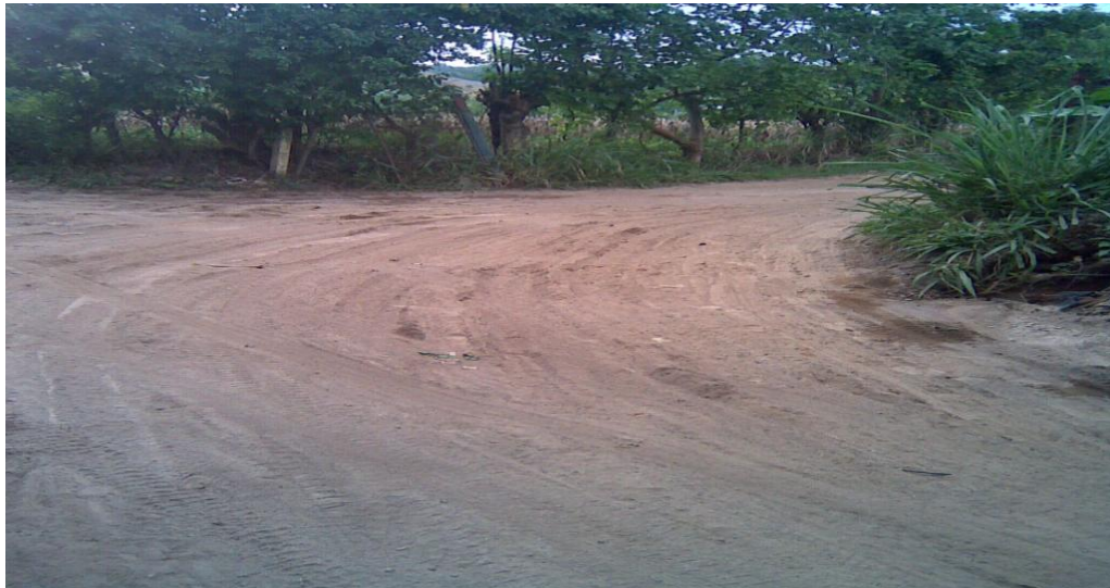
FIGURA 6.7 FOTO DE AHUELLAMIENTO.
