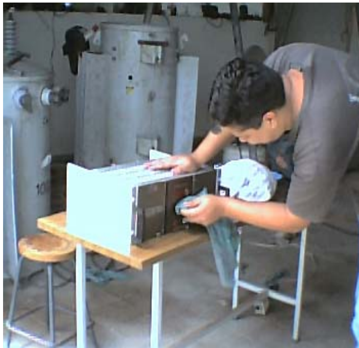
Figura 3.13. Limpieza de unidad de control del espinterometro de medición.
