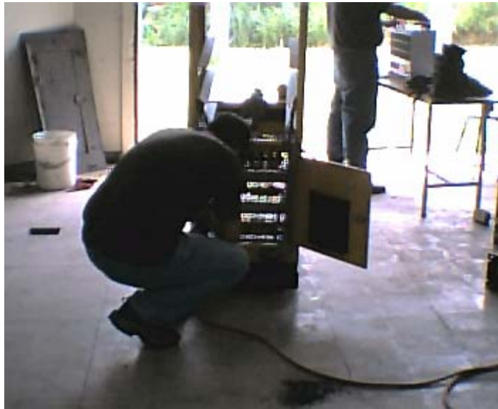
Figura 3.10. Limpieza del panel de control
