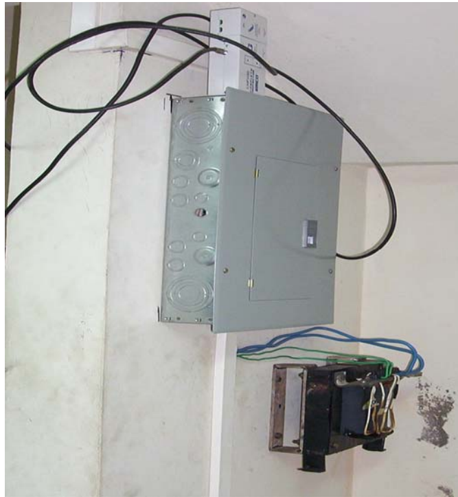
Figura 3.41 tablero de alimentación con transformador de aislamiento.
