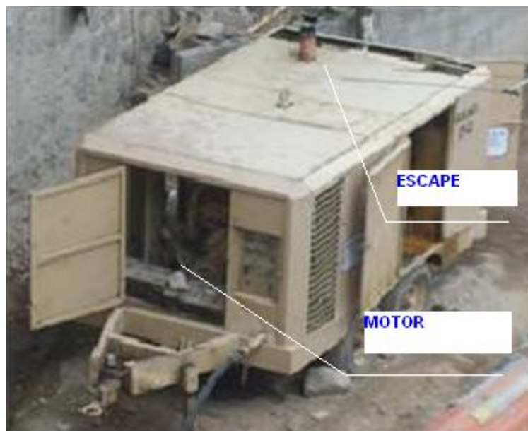
Figura 4. 5 Compresor para bomba de inyección.
