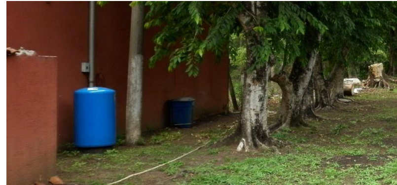
Imagen UR-09: Tanque de abasto para baterías sanitarias Fuente: Orellana, D. 2019
