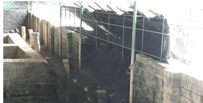
Imagen B-14: Desplome de muro de obraje del añil.
