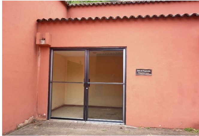
Imagen AR-01a: Vista Exterior, sala audiovisual clausurada por daños Fuente: Orellana, D. 2019
