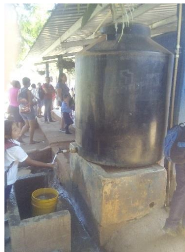
Fig. 15. Tanque para agua potable
