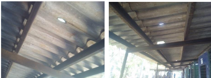
Fig. 13. Techo de pasillos: Deteriorado
