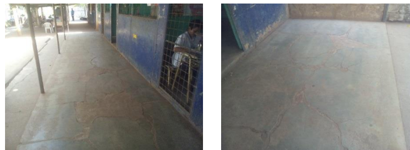
Fig. 11. Piso de pasillos deteriorado
