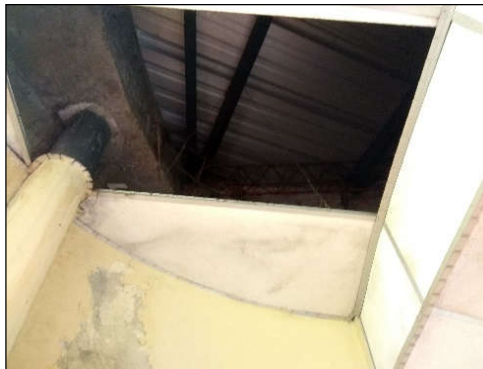
Ilustración 5.7 Losetas de cielo falso faltantes
