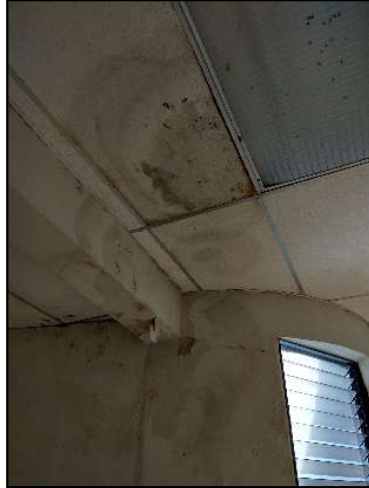
Ilustración 5.3 Cielo falso dañado por filtración
