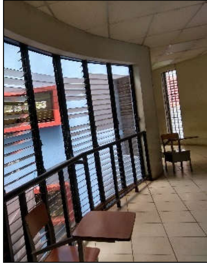
Ilustración 5.6 Celosía faltante en ventana de pasillos y aulas
