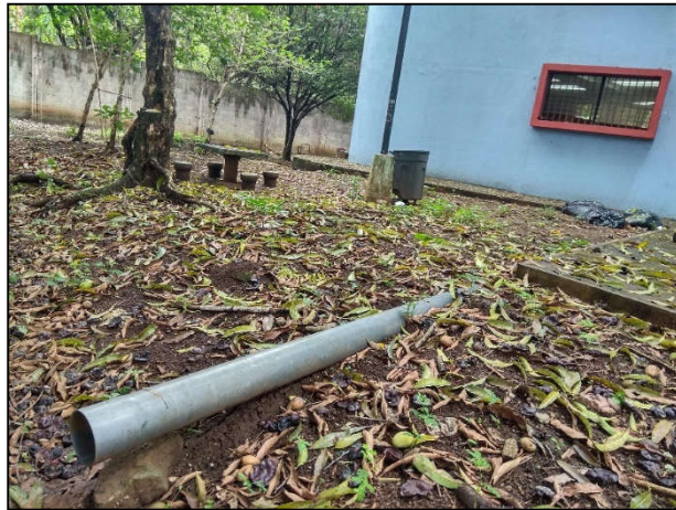
Ilustración 5.12 Tuberías de drenaje de aguas lluvias Fuente: Elaboración propia
