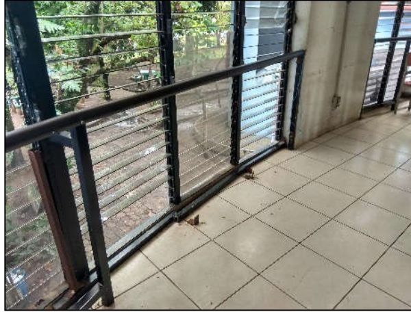
Ilustración 5.8 Falta de elementos verticales en barandal
