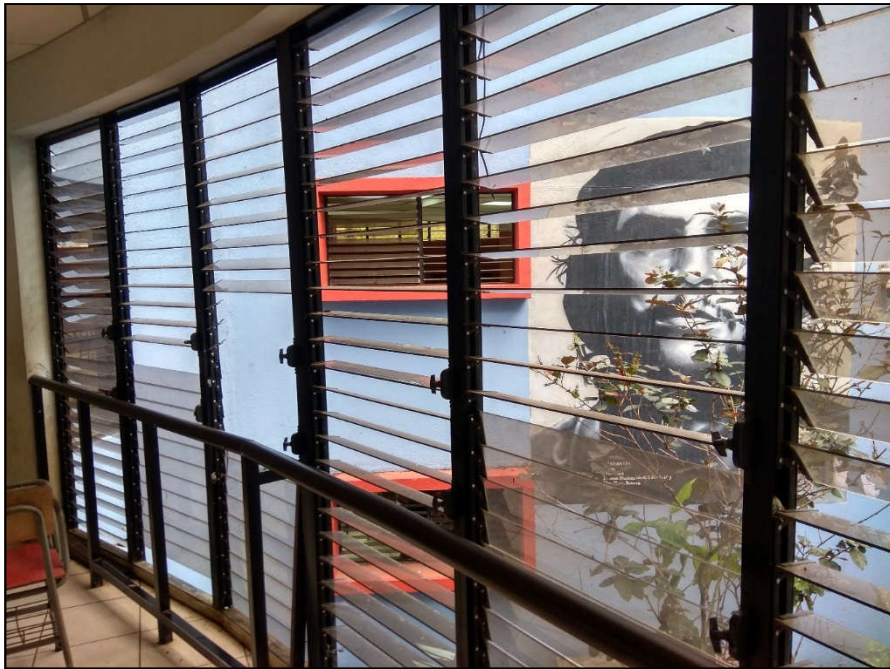
Ilustración 5.17 Ejemplo del estado de ventanas
