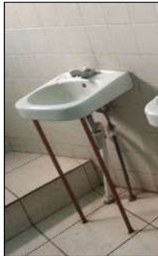
Ilustración 5.4 Perilla de lavamanos dañada
