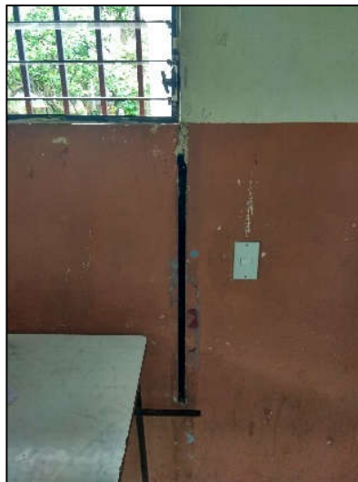
Ilustración 5.5 Pared sin sello en junta de dilatación, vista interior.
