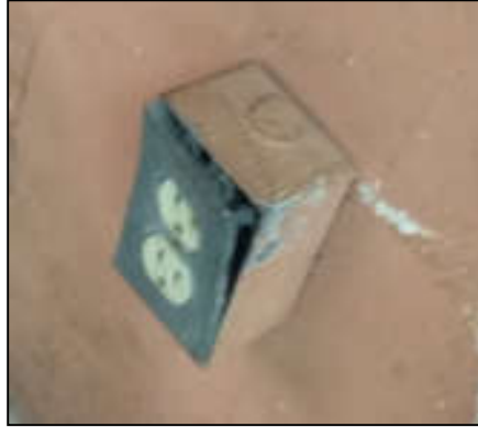
Ilustración 5.10 Tomacorrientes dentro de la Infraestructura
