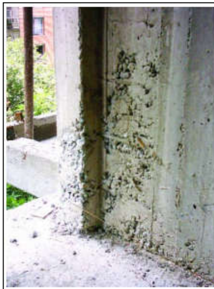
Ilustración 2.3 Mala colocación de estribos
