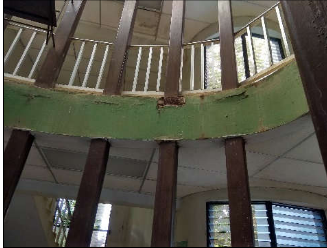
Ilustración 5.4 Elementos verticales con corrosión en vano central del Edificio Bunker.
