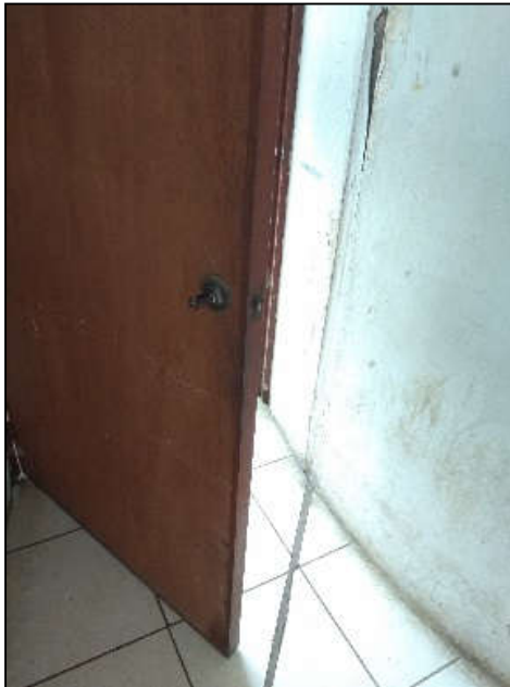
Ilustración 5.5 Chapa de puerta inservible
