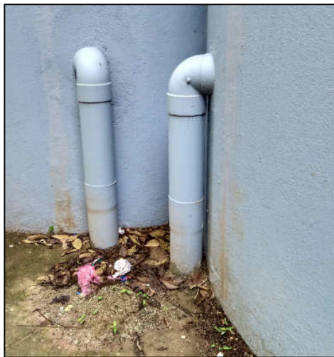
Ilustración 5.13 Tuberías de aguas negras Fuente: Elaboración propia
