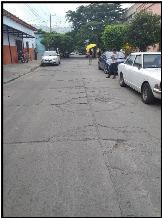
Grieta de esquina, Nivel de severidad: H
