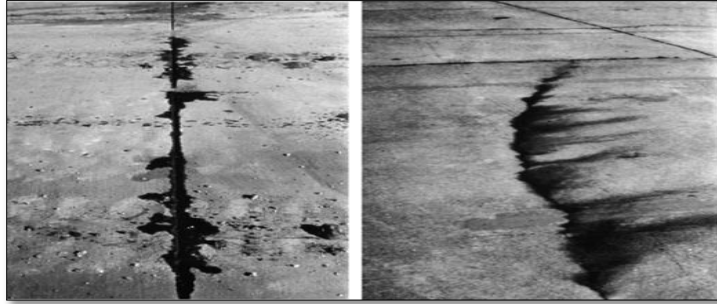
Imagen 2. 36. Bombeo no tiene niveles de severidad definidos.
