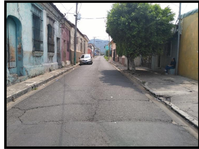
Fisuras en bloque, Nivel de severidad: M
