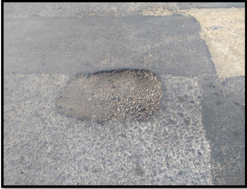
Baches, Nivel de severidad: H
