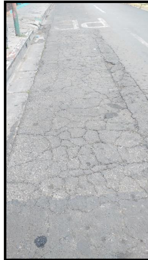
Piel de cocodrilo, Nivel de severidad: H
