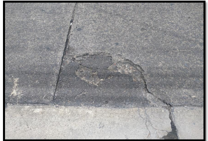
Grieta de esquina, Nivel de severidad: M
