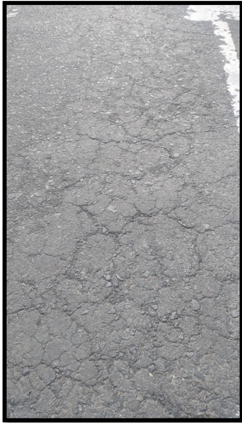
Piel de cocodrilo, Nivel de severidad: M
