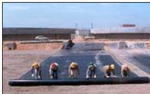
Fig. 11 Geomembrana de polietileno
