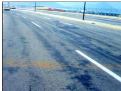
Fig. 71 Exudación de asfalto.
