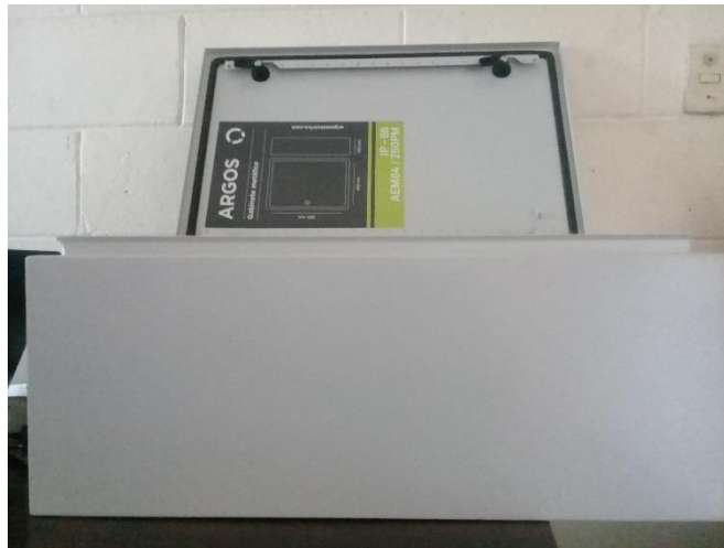
Figura 74. Gabinete metálico, medidor trifásico.
