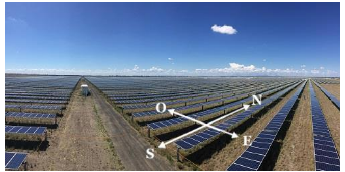
Figura 3.68: Seguidor horizontal 1 eje, movimiento Este-Oeste
