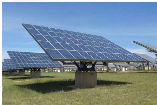
Figura 3.73: Seguidor de doble eje.
