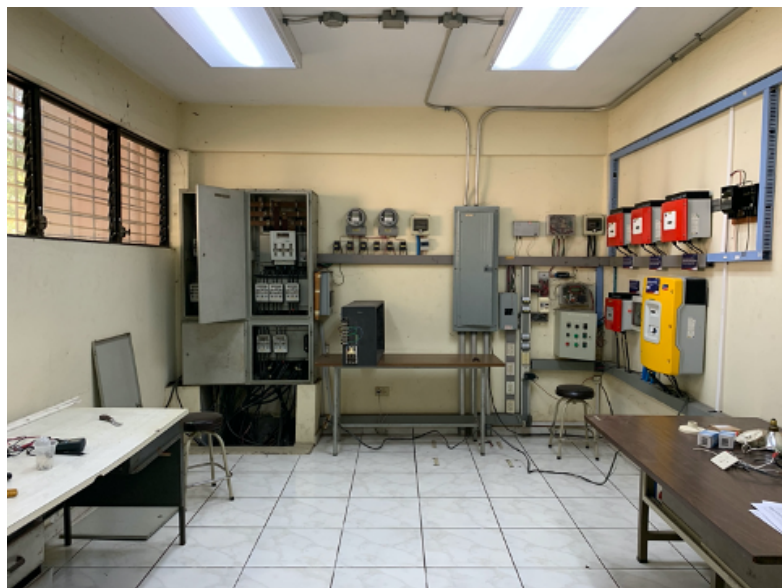
Figura 4: Vista interior: Cuarto de sistema de alimentación de energía de la escuela, y sistema fotovoltaico conectado a la red.
