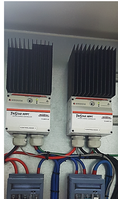
Figura 5.45. Ejemplo de controladores de carga con MPPT.
