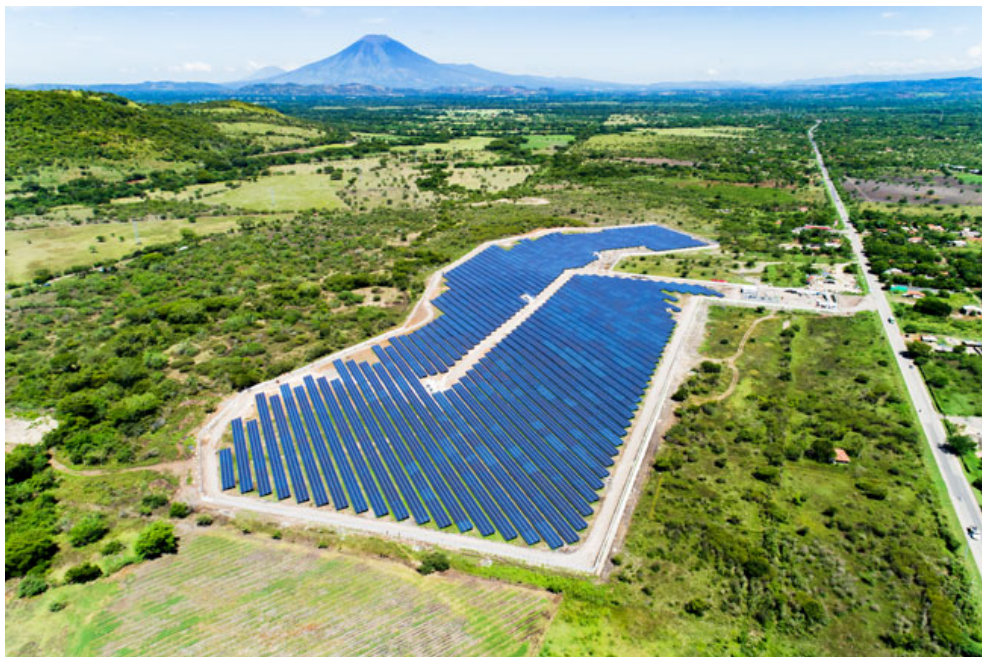
Figura 4.2: Ejemplo de Instalación fotovoltaica sistema Estatico sobre suelo. Proyecto Bósforo El salvador 100MW. [51]
