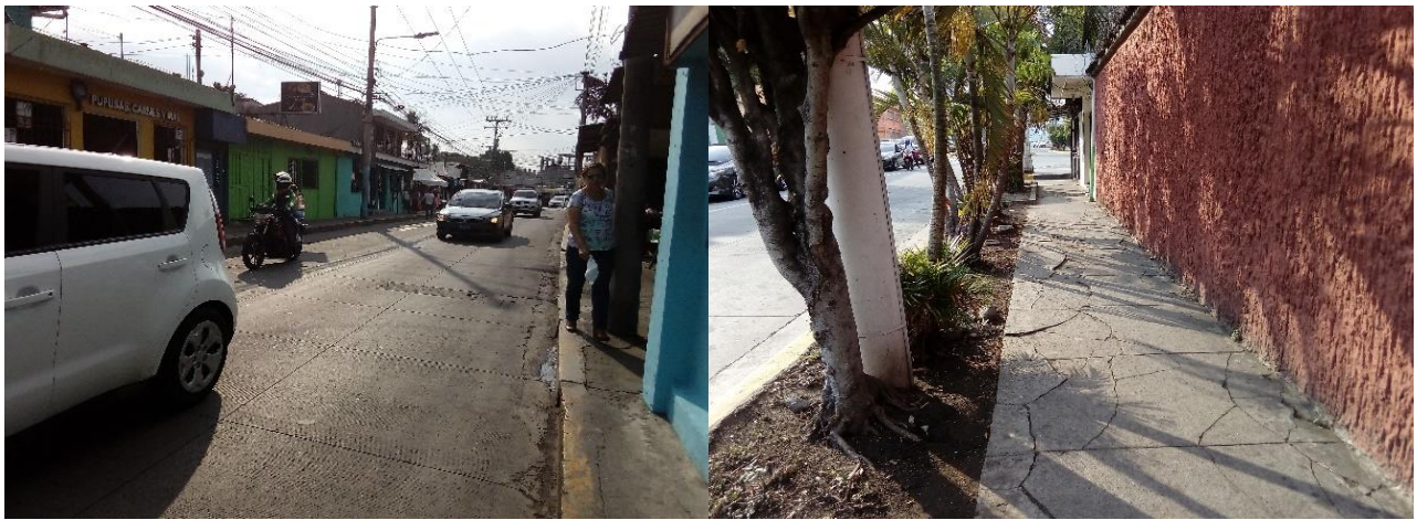
Imagen No. 24: Estado Actual de aceras
