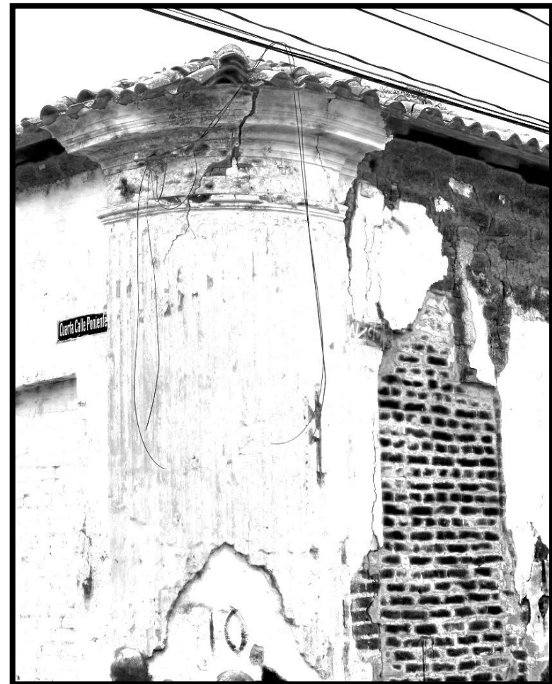
Imagen 2: Deterioro de Inmuebles Patrimoniales.
