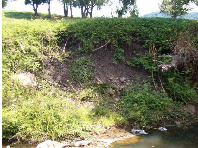
Figura 3.2.1.3 Corte en la superficie del terreno debido al paso del agua de una quebrada
