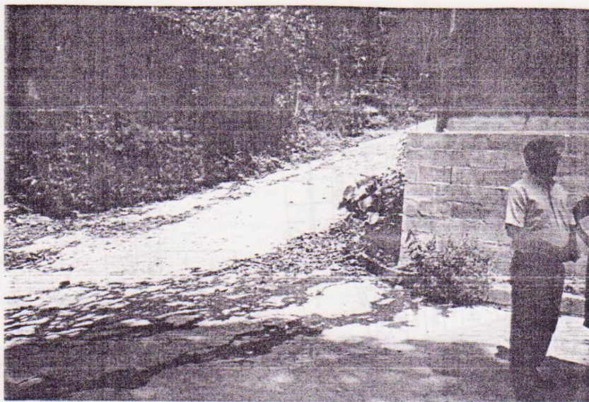
Fotografía 4. Pasaje de la Colonia Monte Campo María donde se muestra que a pesar de haber sistema de aguas negras no todos los lotes están conectados, acceso vehicular concreteado, con drenaje superficial de A.N.
