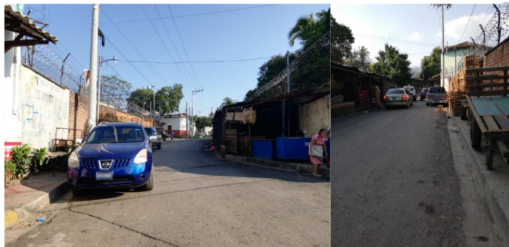
18 Ave. Sur - (Ambas Vistas) Esta Avenida conecta con la Calle Aldea San Antonio, su capa asfáltica se encuentra en buenas condiciones y en cuanto a las aceras estas son ocupadas por vendedores para guardar su mercadería u ocupadas como bodegas limitando así el acceso peatonal a las instalaciones de Ángeles Descalzos, esta Avenida es de un solo sentido siendo este del Sur hacia el Norte.
