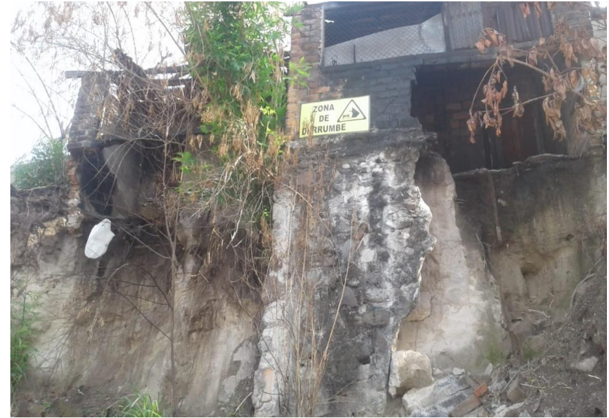
FOTOGRAFIA 08. Zona de derrumbes, infraestructura colapsada, erosión del terreno al costado sur del terreno. Fuente: Elaboración propia, 2019.
