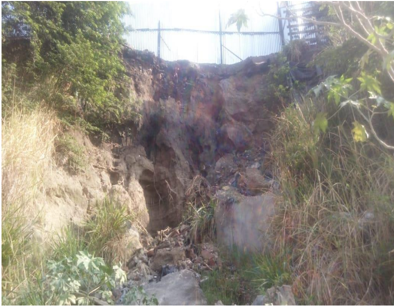
FOTOGRAFIA 07. Erosión de taludes al costado sur del terreno. Fuente: Elaboración propia, 2019.
