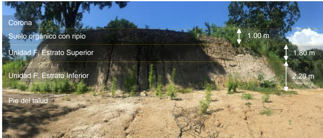
Figura No 4.5 Representación de los materiales presentes en el talud No2 UES del punto No 2 en la zona de La Bóveda dentro del Campus universitario de la facultad de Ingeniería y Arquitectura
