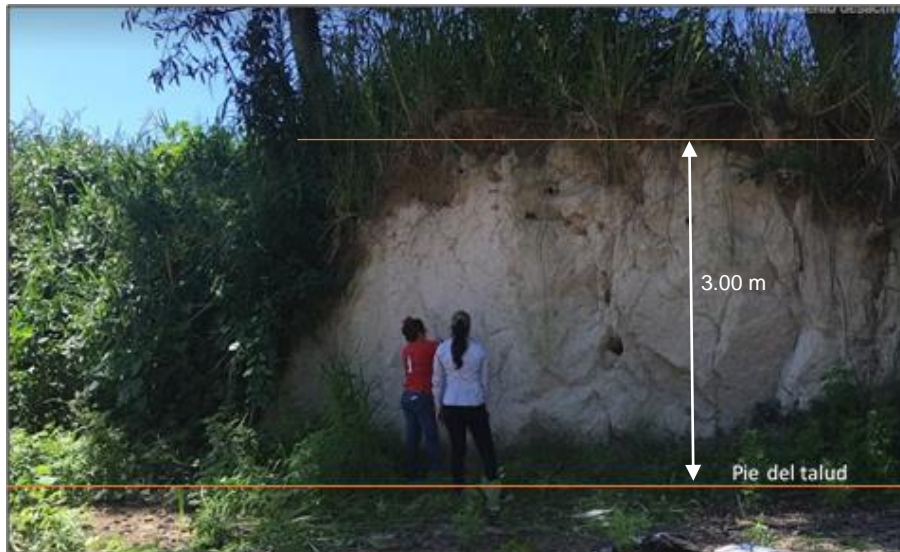
Figura No 4.2. Talud No1 UES del punto No 1 en la zona de La Bóveda dentro del Campus universitario de la Facultad de Ingeniería y Arquitectura
