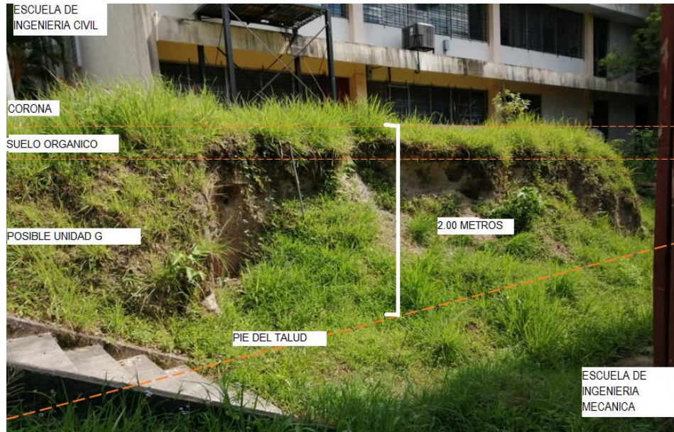
Figura No 4.8. Representación de los materiales que conforman el talud No 3 UES en la FIA, y su ubicación entre la escuela de Ingeniería Civil e Ingeniería Mecánica
