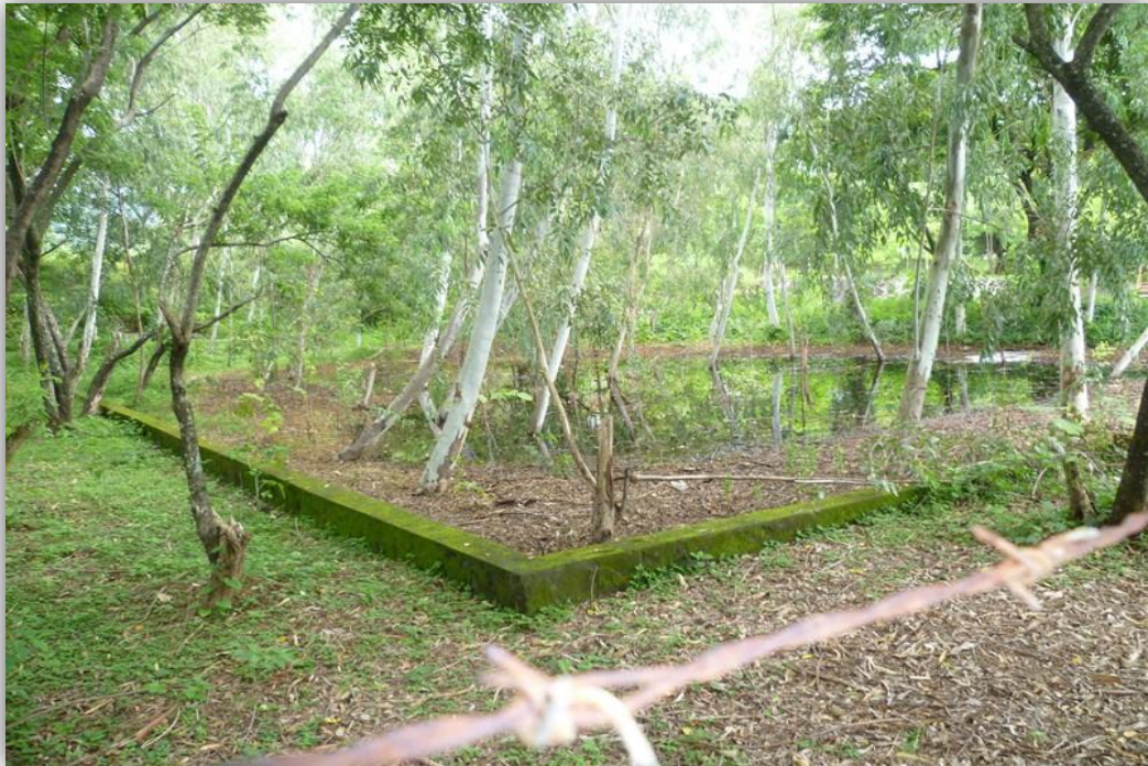
Foto 3.3.5 Contenedor de las aguas resultantes del proceso productivo en la Central geotérmica de Berlín, tomada el día viernes, 29 de julio de 2011, a 04:23:35 p.m., por las Unidades Ambientales de los municipios de Berlín, Mercedes Umaña y Alegría, todos del departamento de Usulután.
