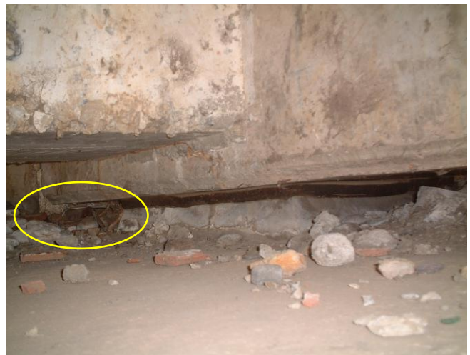
Aparato de Apoyo con daño en el concreto y desprendimiento de acero corroído.
