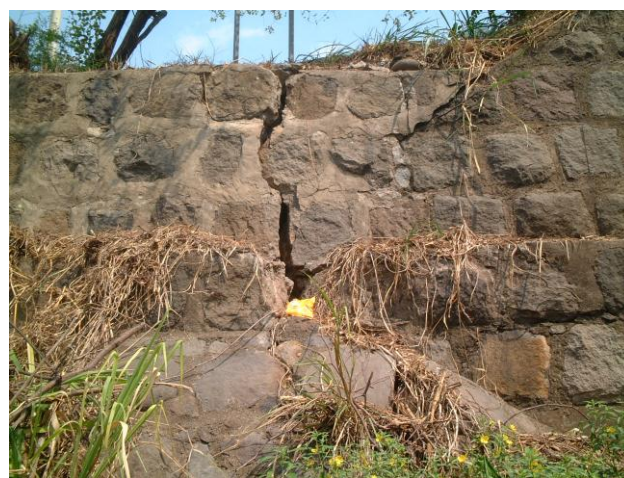
Muro de mampostería con presencia de grietas
