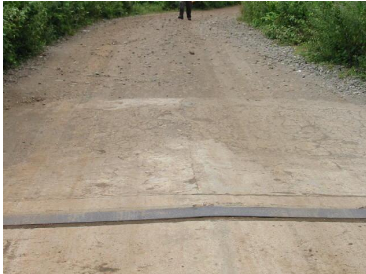
Fig. 4.55. Intrusión de Material y Corrosión de Placa Deslizante en Junta.
