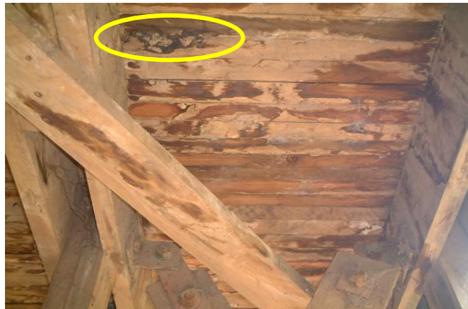
Fig. 4.36. Presencia de Hongos en Tablones de Rodadura.
