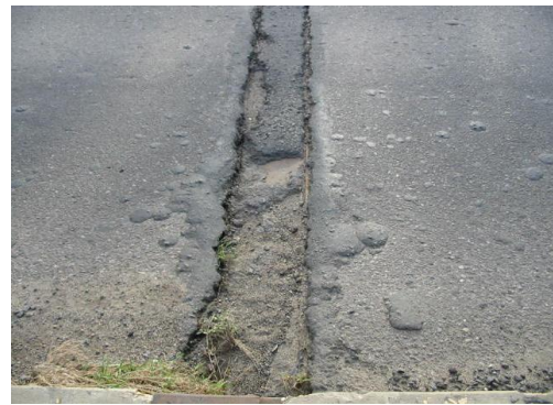
Pérdida de Sello Asfáltico
