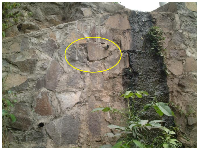
Muro de alas con presencia de humedad y fisuras en el mortero
