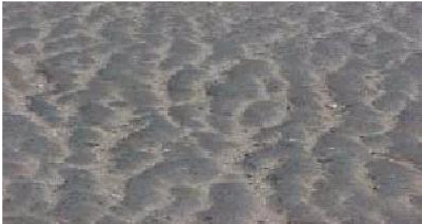
Fig. 4.44. Fotografía de Corrimiento en calzada.
