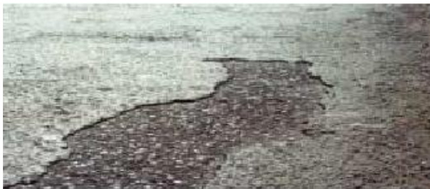
Fig. 4.22. Esquema: Degradación de concreto medio-severo en superficie de rodamiento.
