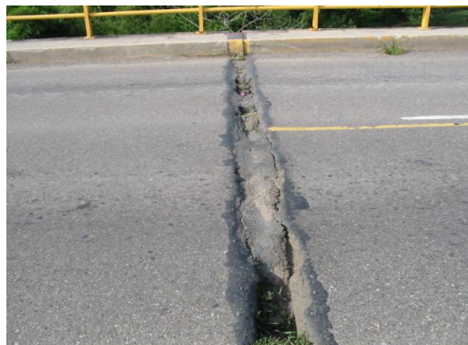
Hundimiento y Pérdida de Sello
