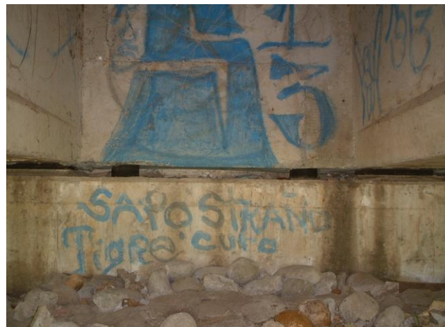
Aparato de Apoyo con presencia de acero corroído.
