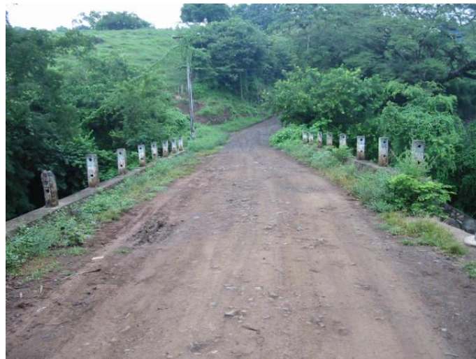
Presencia de Erosión y Pérdida de Material
