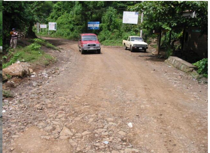
Presencia de Erosión, Pérdida de Material y sección de la calzada
