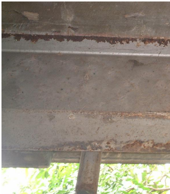
Fig. 4.32. Fotografía: Viga de acero con presencia de degradación de la pintura.
