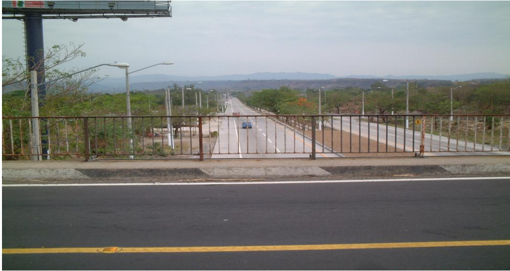
a) Barandales de acero
