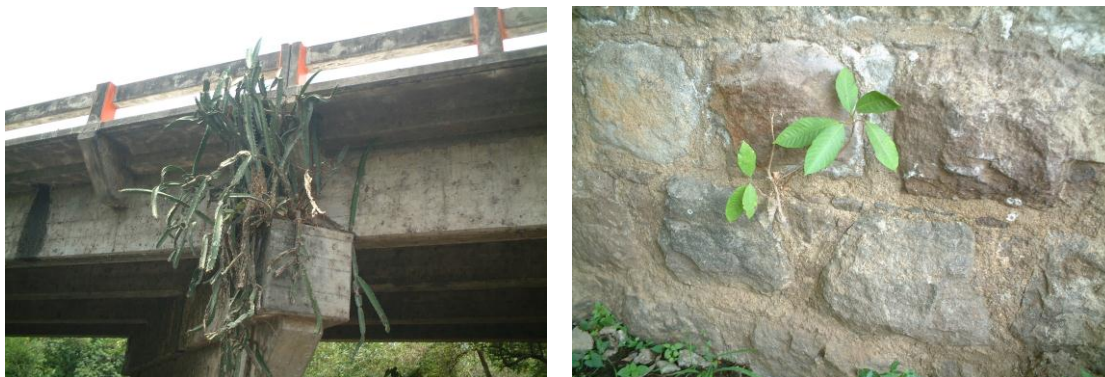
Fig. 4.69. Maleza en elementos de puentes.
