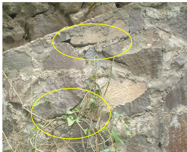
Muro de alas con presencia de degradación y fisuras en el mortero
