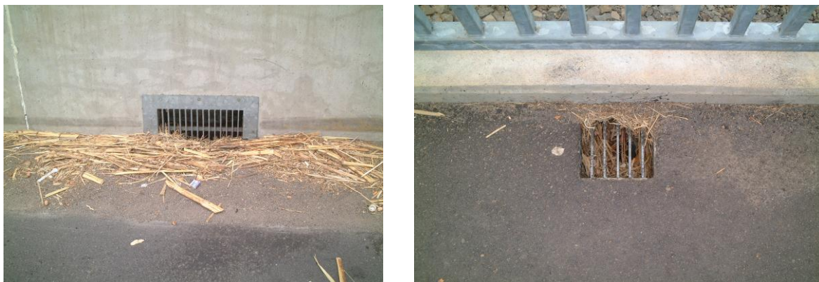
Fig. 4.66. Fotografía: Rejillas con Obstrucciones.
