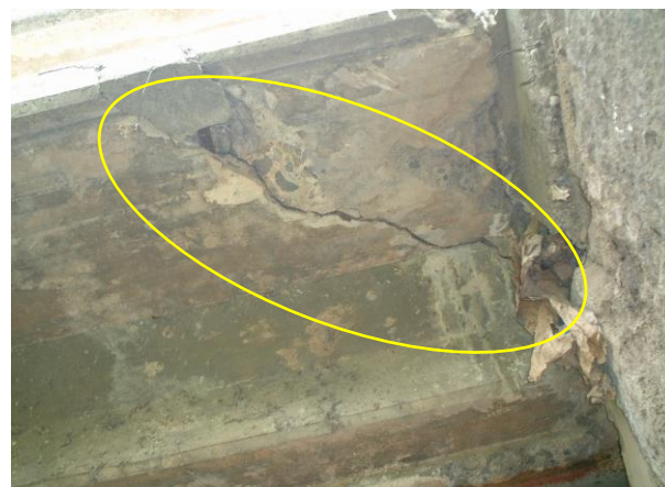
Grieta por cortante bajo la losa
