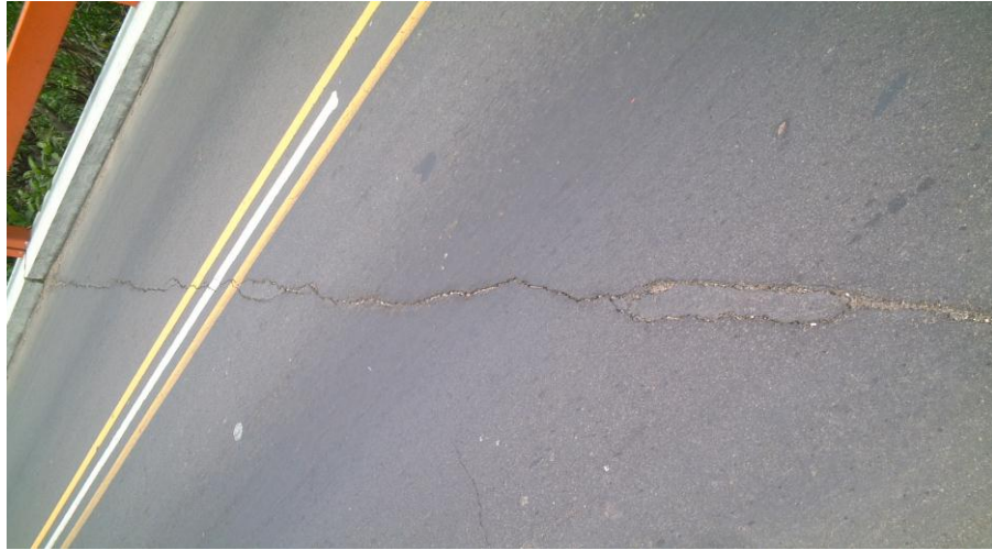
Fig. 4.43. Fotografía de Fisura por reflexión de junta en calzada.
