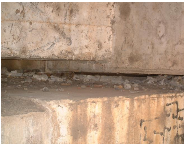
Fotografía que muestra la necesidad de limpieza en aparatos de apoyo.
