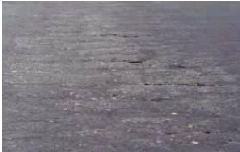
Fig. 4.40. Fotografía de Calzada con fisuras en arco.
