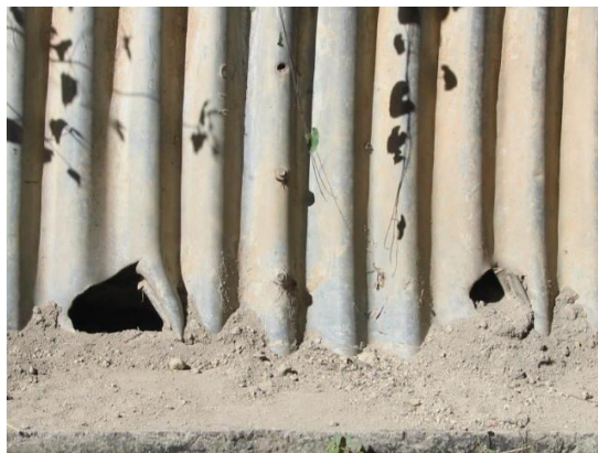
Presencia de pérdida de sección
