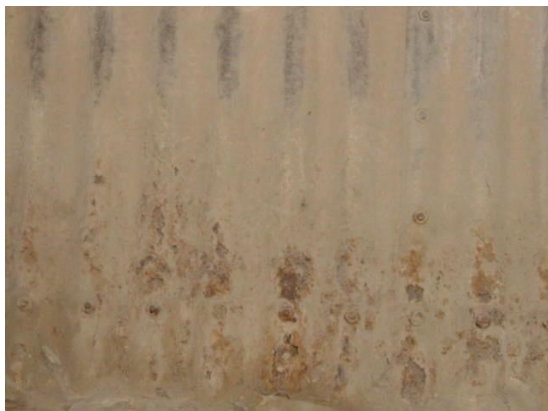
Presencia de corrosión y pérdida de la capa de pintura
