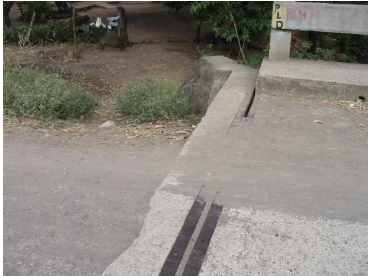
Fig. 4.54. Intrusión de Material en Junta Abierta.
