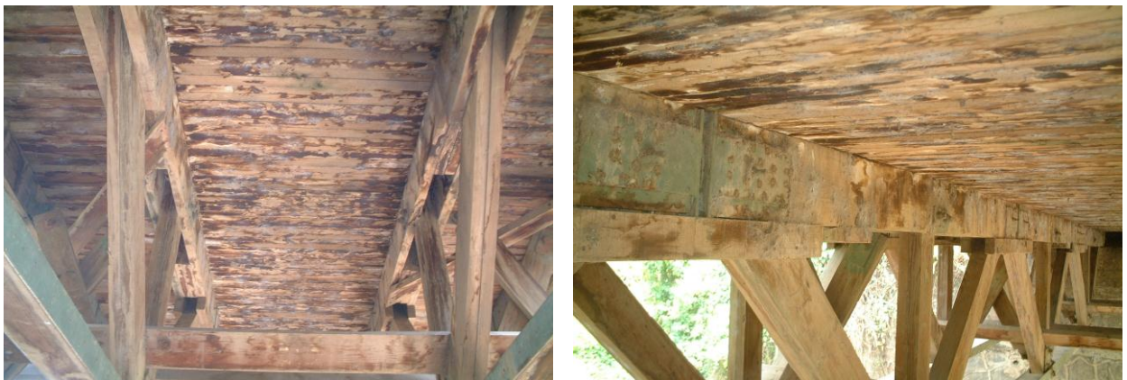
Fig. 4.35. Evidencia de Pudrición en Tablones de Rodadura y Vigas a causa de la Humedad.
