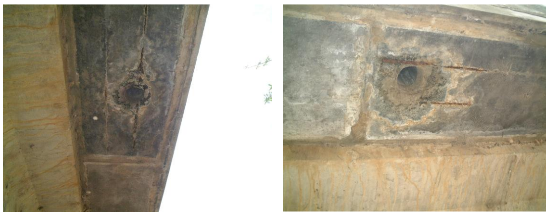
Fig. 4.65. Fotografía: Corrosión del Acero Estructural y Losa de Acera a causa de caídas cortas que drenan directamente bajo el puente.
