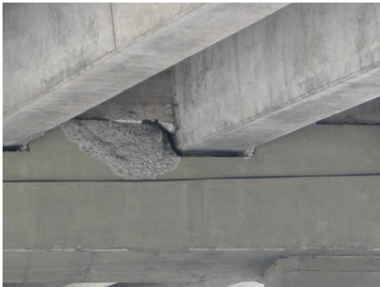
Fig. 4.27. Fotografía Pérdida de Concreto.
