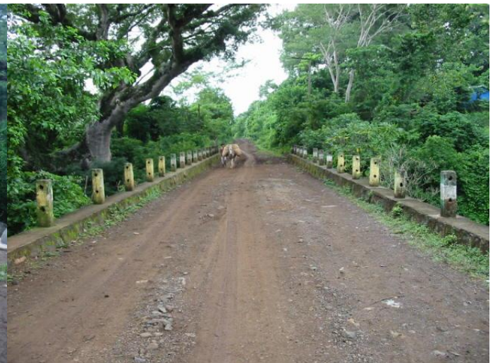
Presencia de Ahuellamiento y Pérdida de Material
