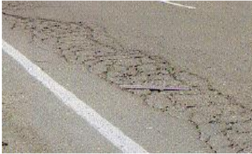
Fig. 4.38. Fotografía de calzada con problemas de piel de cocodrilo.
