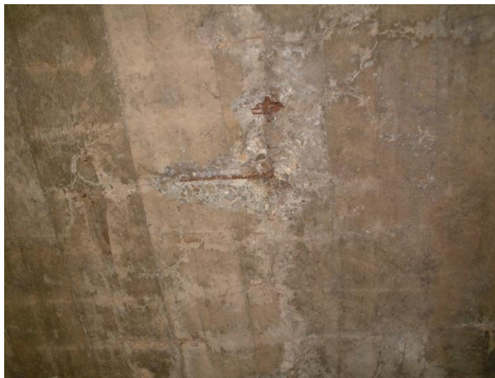
Fig. 4.29. Fotografía: Acero Expuesto bajo la losa.
