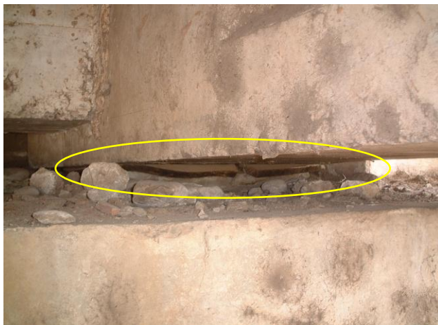
Aparato de Apoyo con presencia de acero deformado y con detritus en su contorno.
