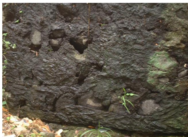
Muro de mampostería con presencia de degradación en el mortero y severa filtración
