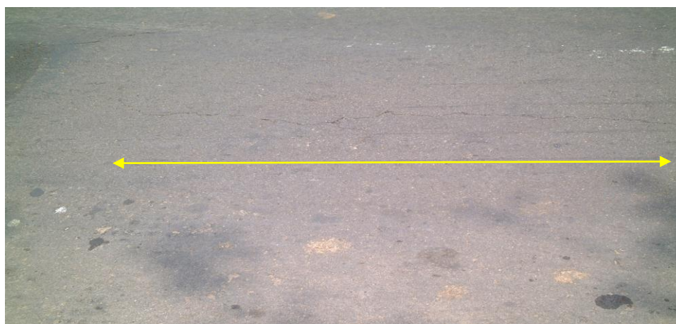
Fig. 4.42. Fotografía de Fisura Longitudinal en calzada.
