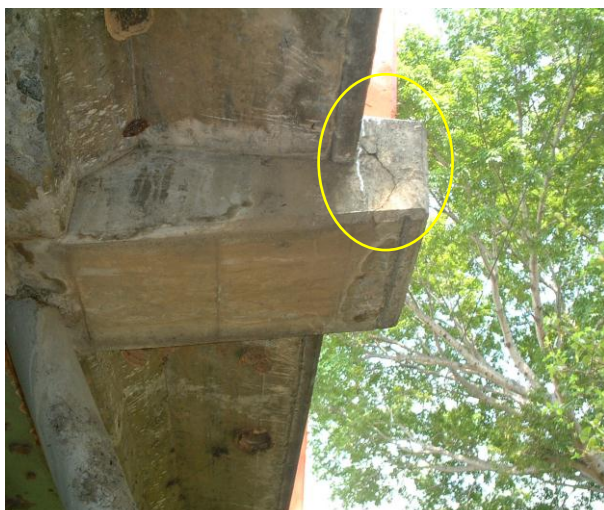
Fisuras en apovo de barandales
