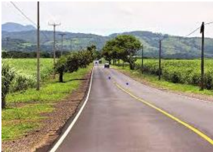
Figura 3.8: Pavimento Flexible CA01E Desvió San Vicente – Kilometro 70.
