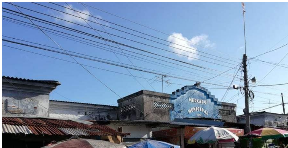
FOTOGRAFÍA 29: La falta de pintura en la mayoría de paredes del mercado es muy notorio creando este un tipo de hogo y deterioro en la estructura por la falta de mantenimiento por parte de la administración. Fuente: Propia.
