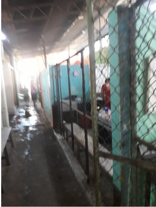
FOTOGRAFÍA 19: Zona de cocinas, se puede observar instalaciones no adecuadas para el consumo de alimentos, por falta de higiene y mal mantenimiento de la zona, Mercado #2. Fuente: Propia.
