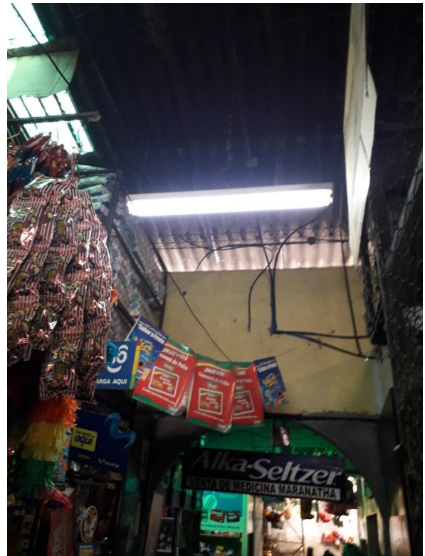
FOTOGRAFÍA 24: Falta de mantenimiento a techos observándose la falta de piezas de techo y sustituidos con lamina no adecuada filtrando la lluvia. Fuente: Propia.
