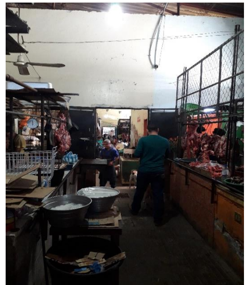
FOTOGRAFÍA 18: Zona de Carnes, invasión de pasillos con productos y además no posee un área de control de calidad e higiene que garantice el producto Fuente; Propia.
