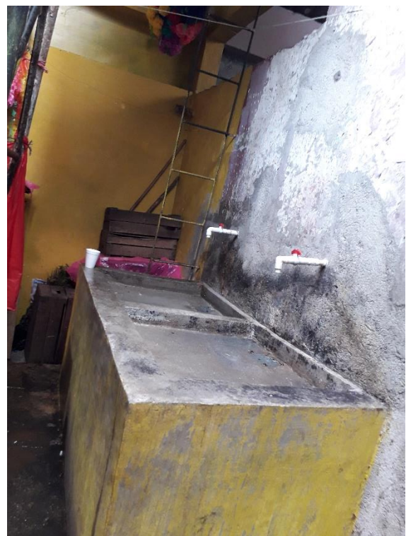
FOTOGRAFÍA 26: Lavaderos del mercado municipal, estructura en mal estado con falta de mantenimiento y los cuales no son higiénicos, Fuente: Propia.
