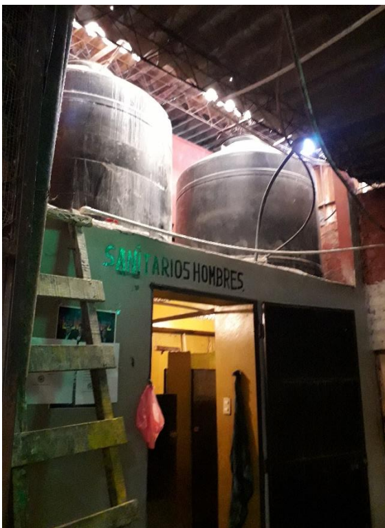
FOTOGRAFÍA 25: Mal estado de Servicios Sanitarios del mercado municipal observándose con mala instalación de tubería y drenaje creando malos olores por falta de higiene. Fuente: Propia.
