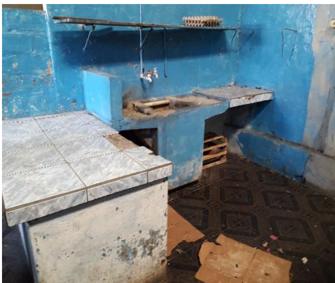
FOTOGRAFÍA 30: Puesto de Cocina destruido en ocasiones vandalizados por falta de seguridad en la zona Fuente: Propia.
