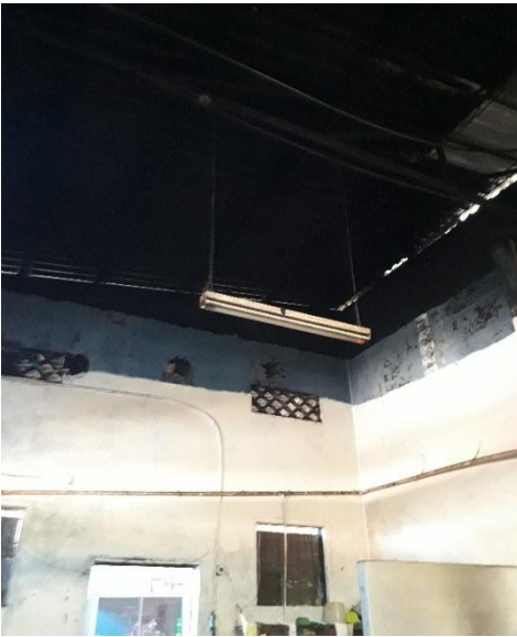
FOTOGRAFÍA 27: Mal estado de la iluminación en zona de cocinas. Fuente Propia.
