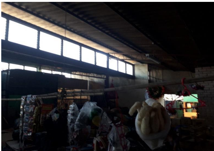
FOTOGRAFÍA 28: Ventanales tipo Solaire no dan abasto a la ventilación natural generando temperaturas muy altas dentro del recinto. Fuente: Propia.
