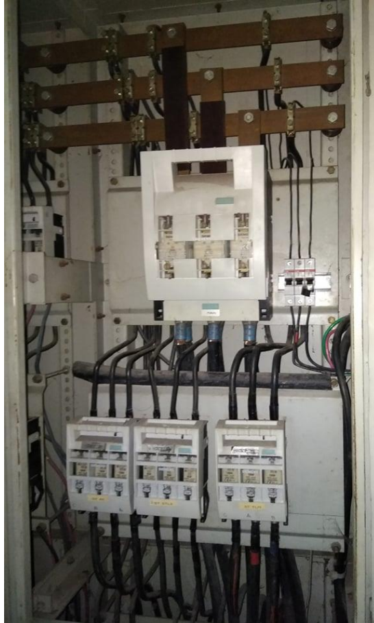
Figura 3.6 Tablero general de la escuela de ingeniería eléctrica.
