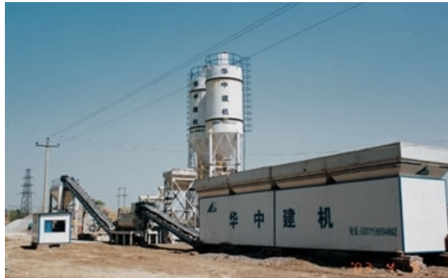
FIG. 4.18. Planta mezcladora de suelo cal.
