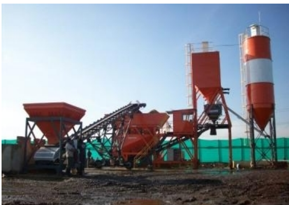
FIG. 4.19. Planta mezcladora de tipo continuo para suelo-emulsión.
