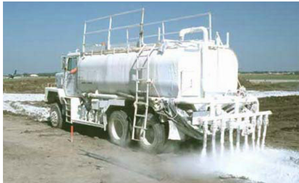
FIG. 4.13. Dosificador de lechada de cal sobre el material de base en un tramo de carretera.
