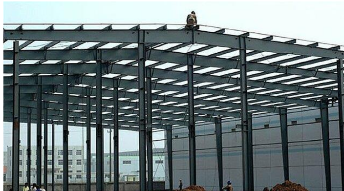
Figura 2. 64 Columnas de acero estructural.
