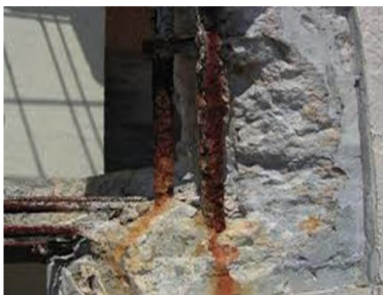
Figura 1. 1 Corrosión del acero de refuerzo.
