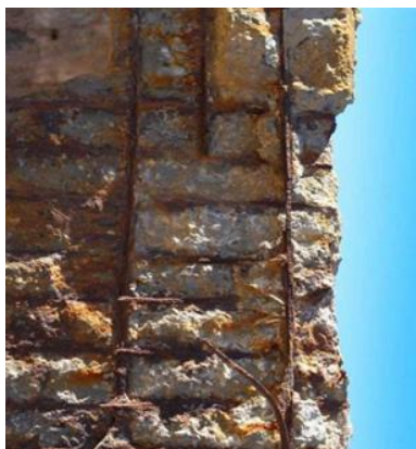
Figura 1. 2 Pérdida de adherencia entre el acero y el concreto.
