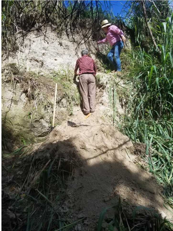
Figura No. 3. 2 Talud ubicado en las cercanías del Colegio Español Padre Arrupe, al borde poniente de autopista de Oro, Soyapango, San Salvador.
