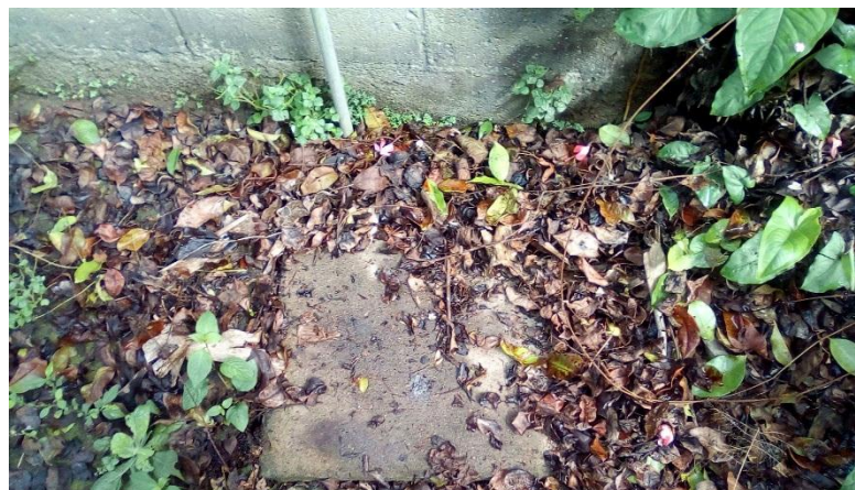
Foto N°15: Acometida de agua potable en terreno colindante Fuente: Foto tomada por el grupo
