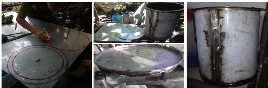
Figura 89. Trazado, corte de las piezas, conformado y unión del fondo al cuerpo cilíndrico.
