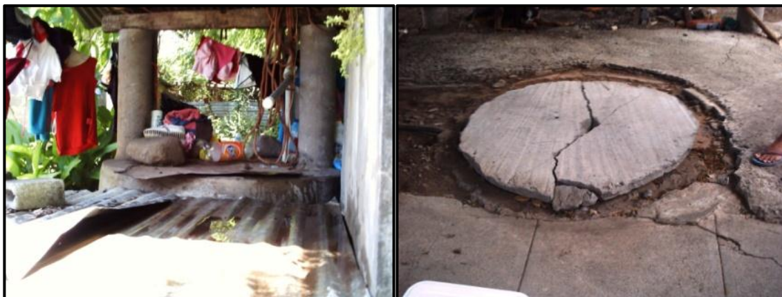
Figura N° 24. Tapa de pozos no adecuada
