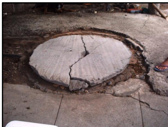
Figura N° 27. Pozo sin reborde de protección
