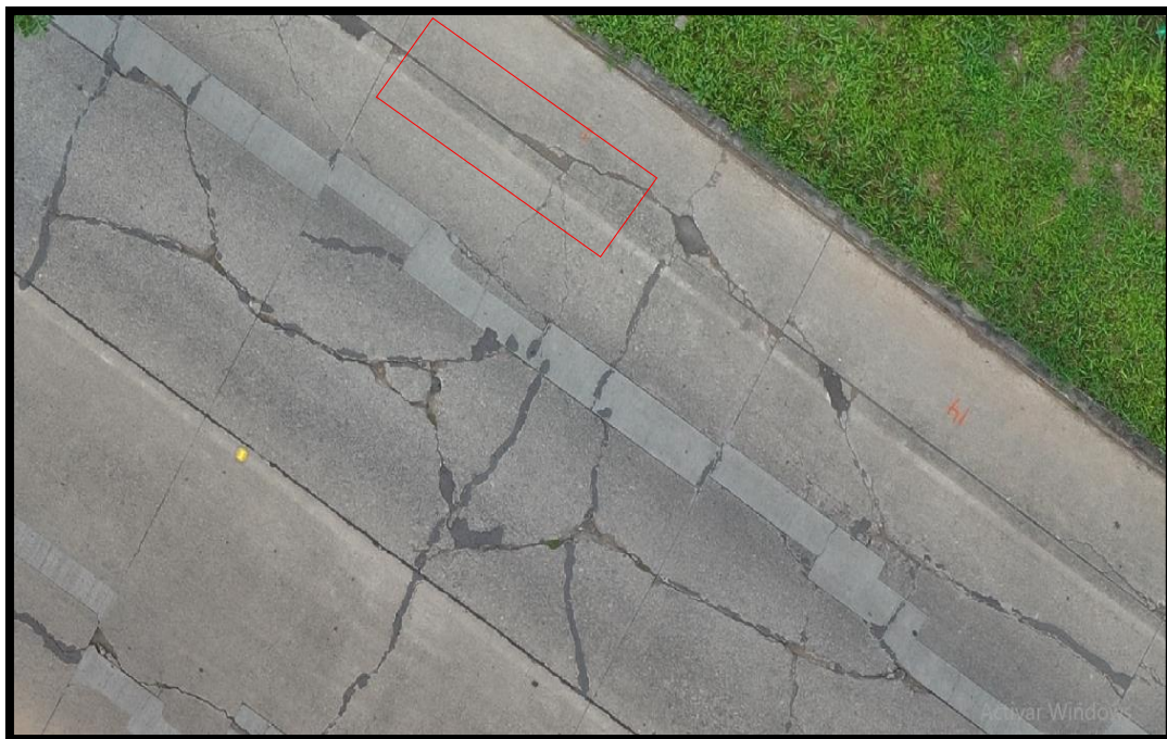
Figura 104: 4.20 Desprendimiento de junta
