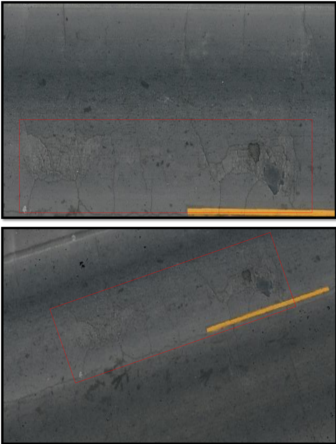
Figura 57: 3.44 Grieta piel de cocodrilo
