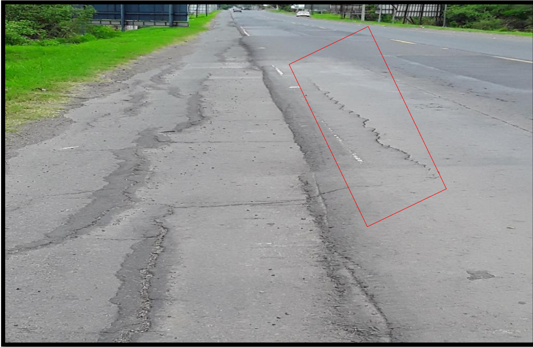
Figura 78: 3.65 Grieta de borde
