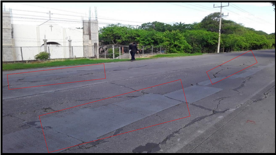
Figura 123: 4.39 Parqueo grande, grietas lineales
