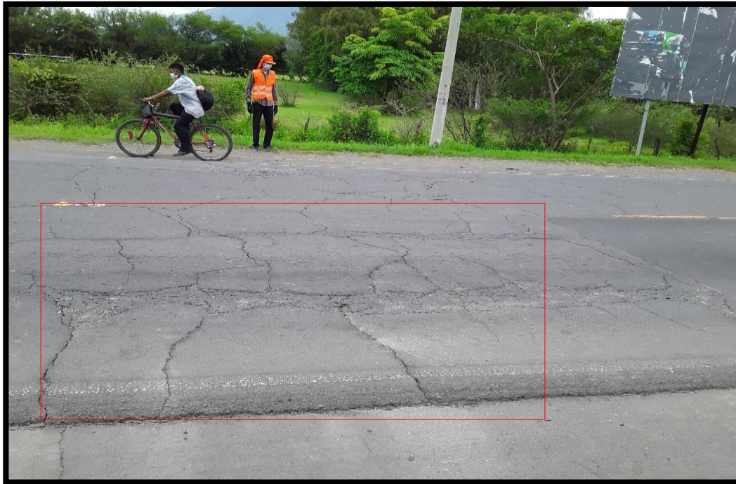
Figura 76: 3.63 Agrietamiento en bloque
