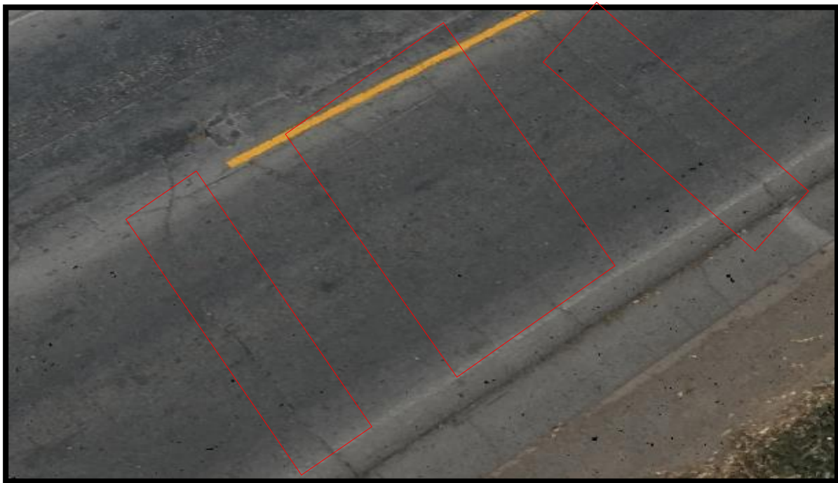
Figura 62: 3.49 Grietas longitudinales y transversales
