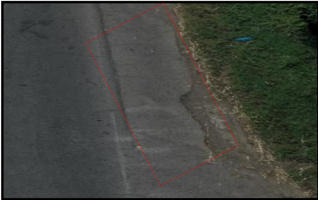
Figura 60: 3.47 Grieta de borde
