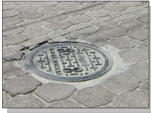
Fotografía No 15 Pozo de Aguas Negras.
