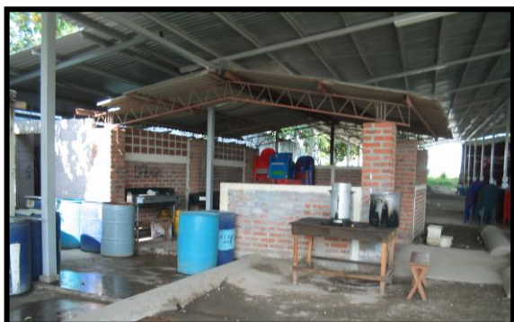
Fotografía 9 Cocina provisional en galera N°1
