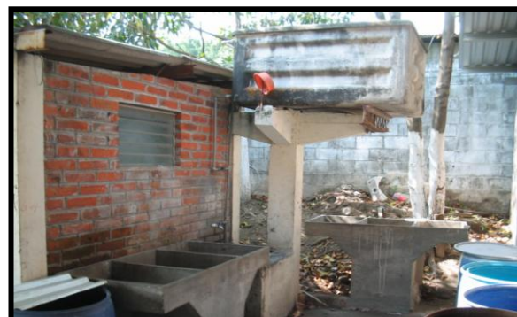
Fotografía 10 Cocina provisional en galera N°1
