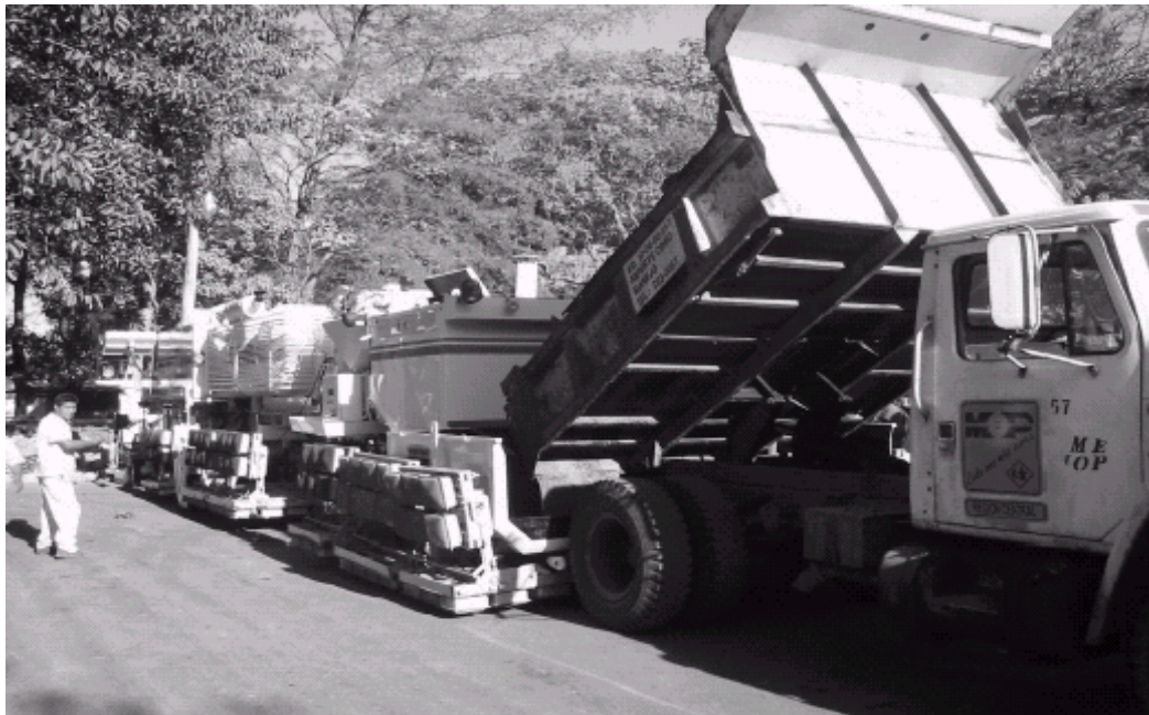
Figura 7.35 La mezcla adicional es cargada en la tolva receptora del Remixer. Durante el transporte al sitio, la mezcla es cubierta con una capota de lona para prevenir un excesivo enfriamiento.
