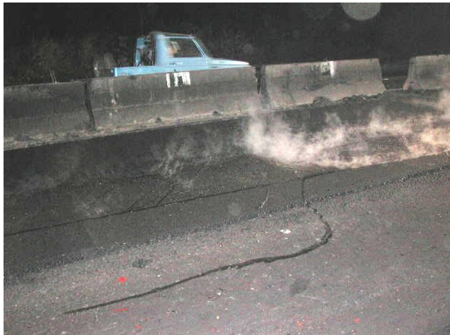
Figura 7.55 Se puede observar la capa ya nivelada como lo deja la máquina Remixer 4500 propiedad del MOP.
