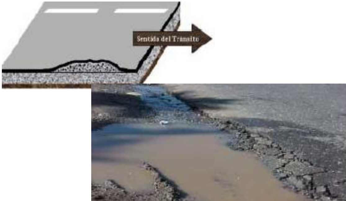
Fig. 3.14 Daño por desintegración de bordes con acumulación de agua.
