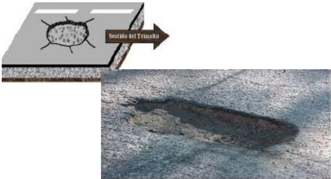
fig. 3.12 Bache con pérdida de material de base.
