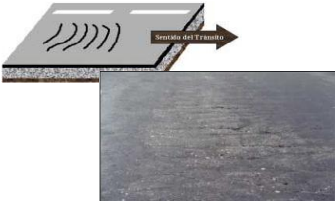
Fig. 3.3 Fisuras en arco
