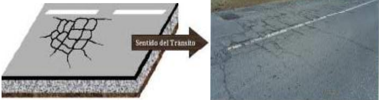
Fig. 3.2 Fisuras en bloque
