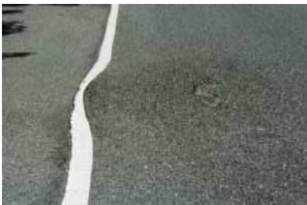
Fig. 3.11 Daño por hundimiento.
