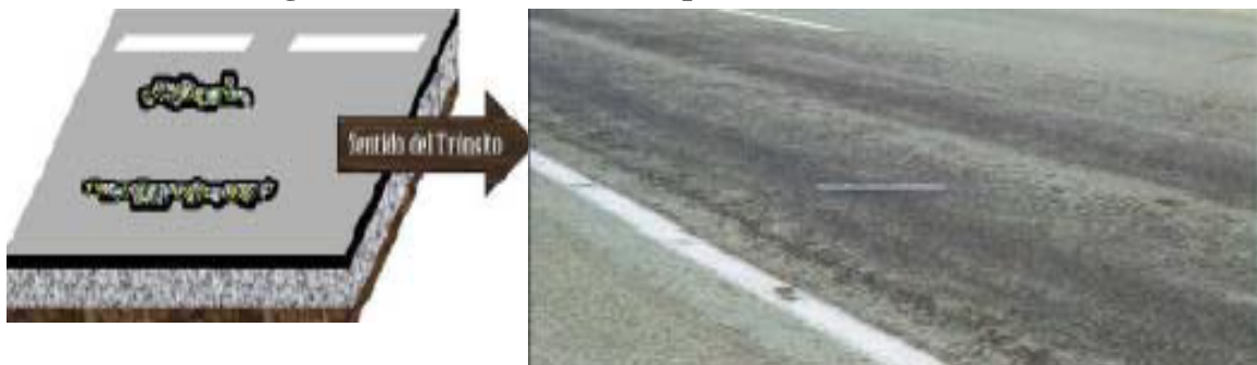
Fig. 3.15 Pavimento dañado por exudación de asfalto.
