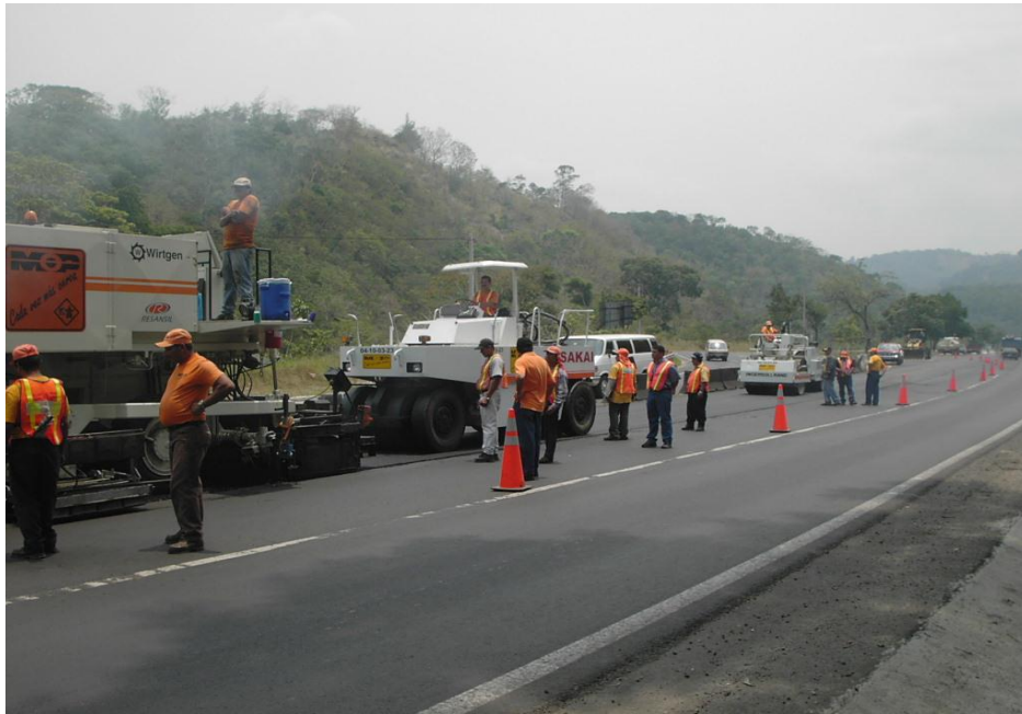
Figura 7.38 Se muestra como se utilizó únicamente el carril a ser reciclado en la carretera hacia Los Chorros, obstaculizando lo menos posible al tráfico, se colocó señales de advertencia y conos de precaución.
