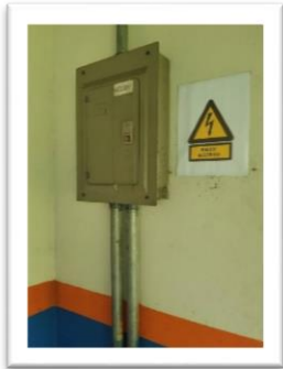
Fotografía 13: Caja térmica del centro escolar
