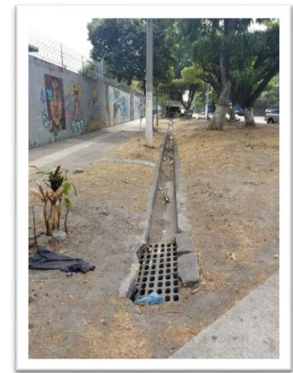
Fotografía 36: Cuneta y tragante sin protección
