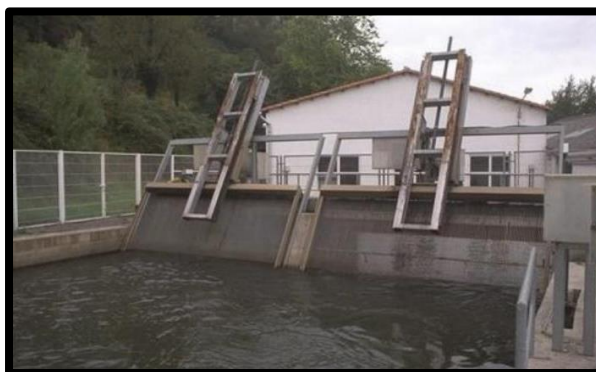
Figura 14. Cámara de Carga.
