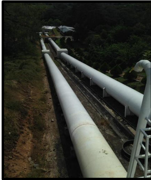
Figura 15. Tubería Forzada, PCH Río Sucio.
