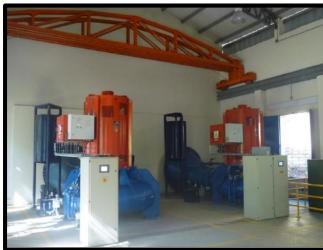
Figura 16. Casa de máquinas.
