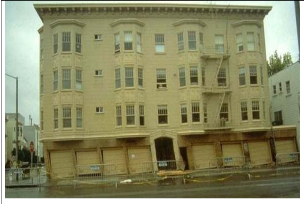
Fig. 2. 60 Efecto de piso débil ( http://www.proteccioncivil.org/pefn/gmartin/gmartin )
