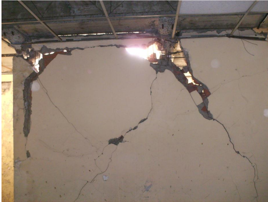
Fig. 4. 16 Pared de relleno que ha fallado, posiblemente por las fuerzas cortantes generadas por la interacción con el marco.
