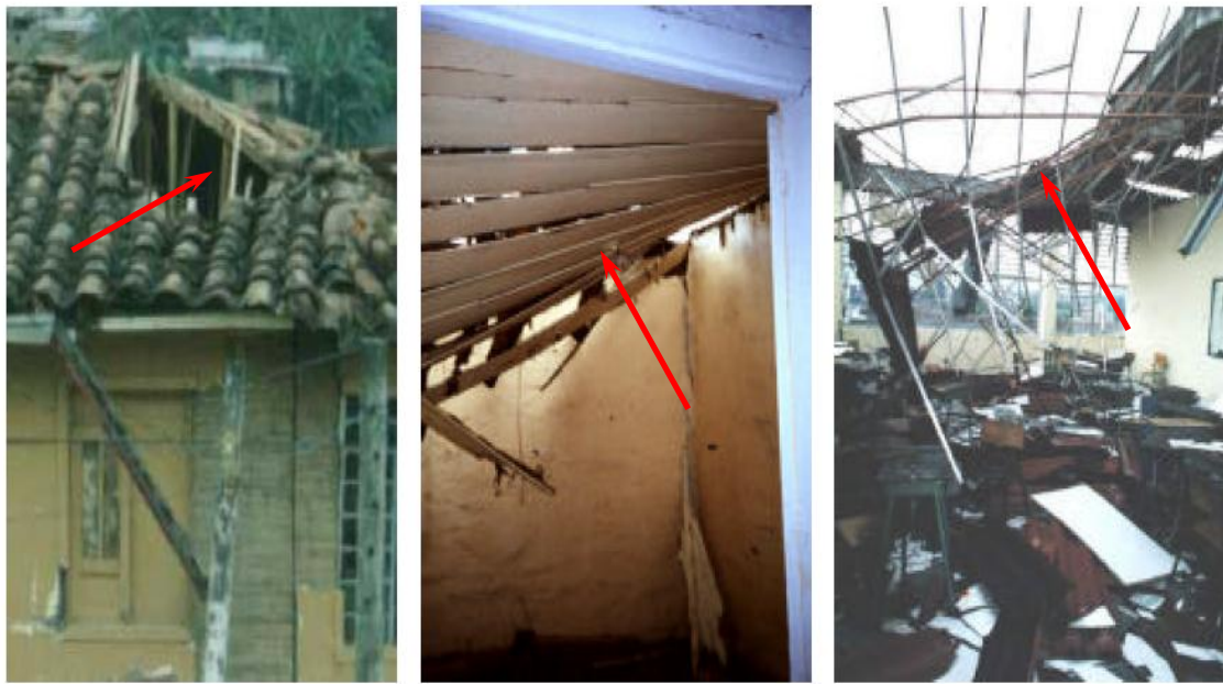
Fig. 2. 73 Caída de algunas piezas de teja (izquierda), problemas de apoyo y caída de las piezas (centro) y colapso del techo de estructura metálica y cubierta de lámina (derecha) (Asociación Colombiana de Ingeniería Sísmica, 2003).
