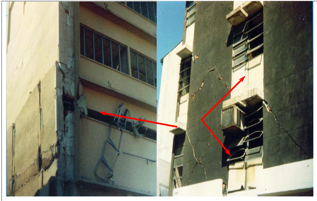
Fig. 2. 66 Desprendimiento y agrietamiento de una pared de fachada (izq.) y agrietamiento diagonal en paredes de fachada (dcha.) (Avalos C., J., 1987).
