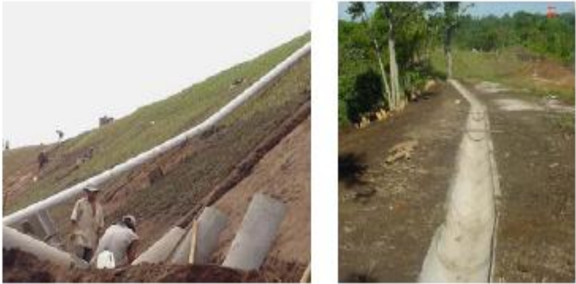
Fig. 2. 112 Cunetas elaboradas con tubos de concreto cortados por la mitad, en el sentido longitudinal (Alberti, J. y otros, 2006).
