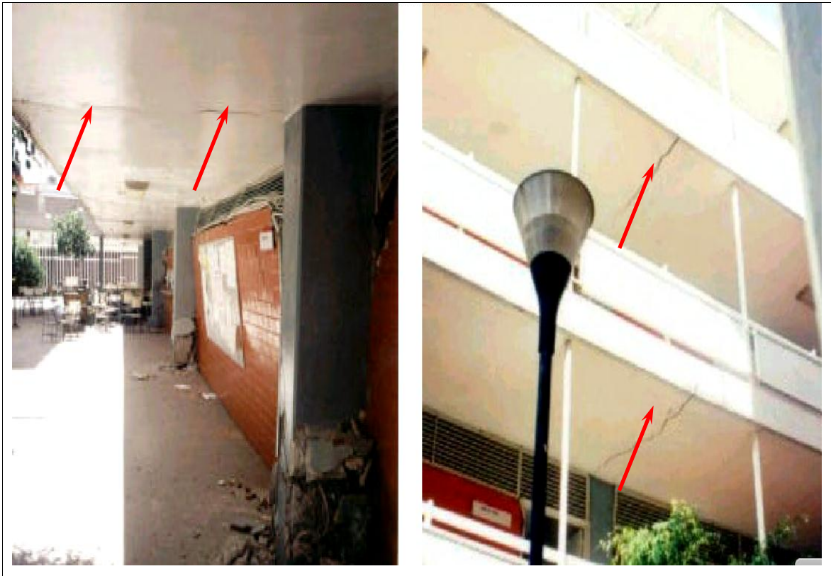
Fig. 2. 52 Grietas en el sistema de entrepiso producidas por flexión ( http://catarina.udlap.mx/u_dl_a/tales/documentos/lic/murillo_j_cg/capitulo5.pdf ).
