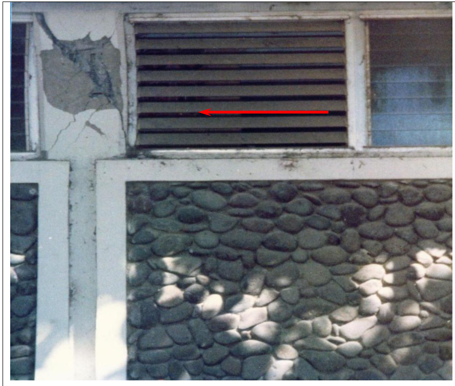
Fig. 2. 64 Efecto de columna corta en un sistema de marco de un edificio luego del sismo del 10 de octubre 1986 en nuestro país (Avalos, J. y otros, 1986).
