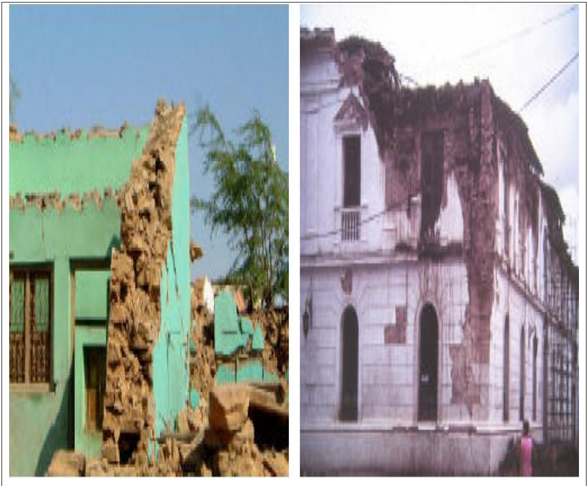
Fig. 2. 38 Falla combinada por cortante, flexión y la caída del techo (Asociación Colombiana de Ingeniería Sísmica, 2003).
