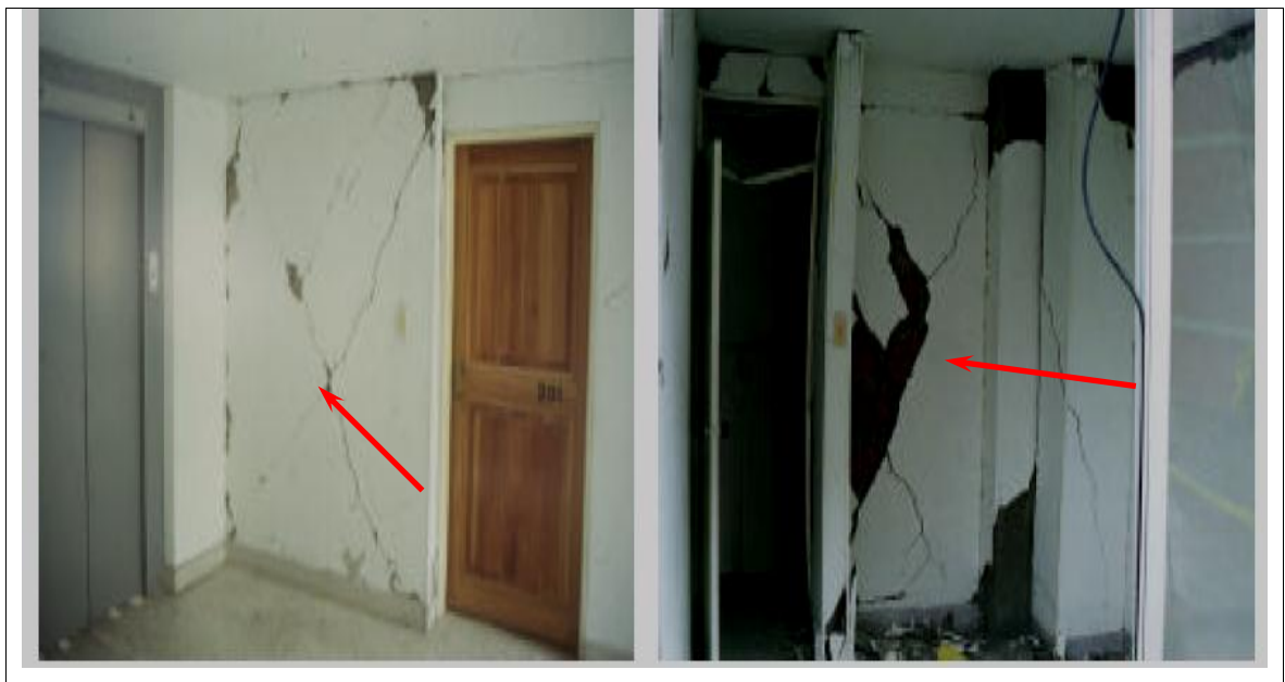
Fig. 2. 70 Agrietamiento y desprendimiento del recubrimiento en paredes divisorias (Asociación Colombiana de Ingeniería Sísmica, 2003).
