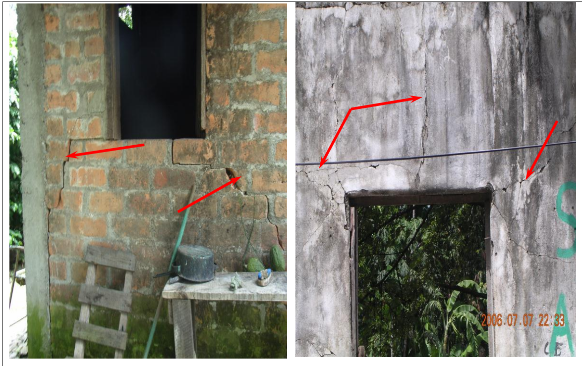
Fig. 2. 37 Daño por cortante y flexión en una vivienda en la comunidad las lomas de Comasagua (izquierda) y en los restos de una vivienda en San. Agustín, Usulután (derecha).
