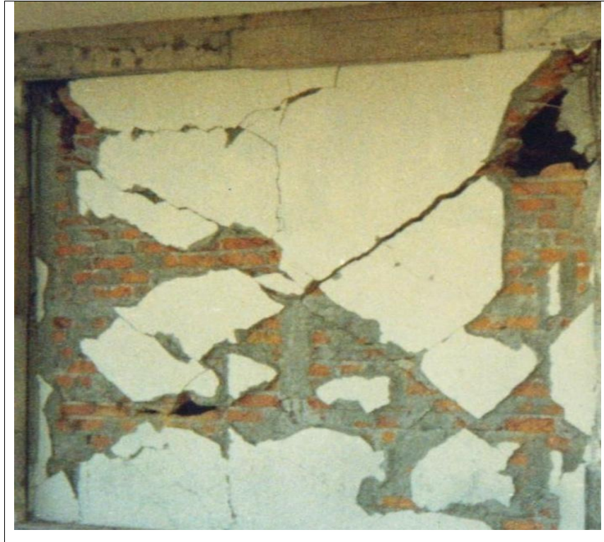
Fig. 2. 69 Agrietamiento y desprendimiento del recubrimiento en pared de relleno (Avalos C., Juan J., 1987).
