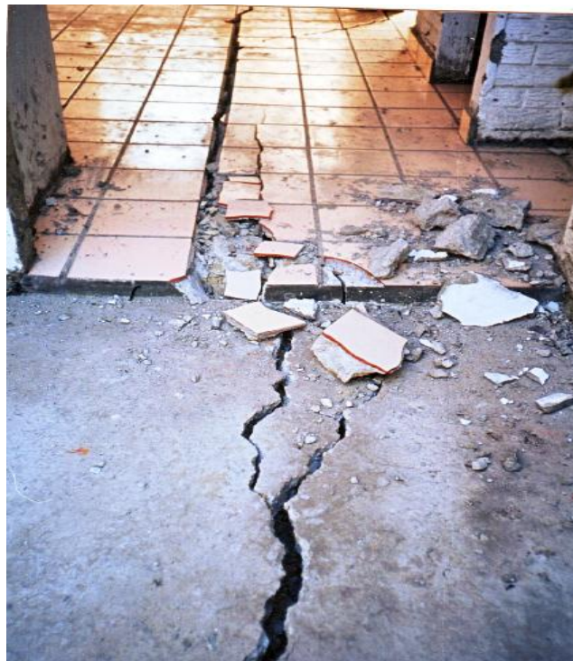
Fig. 2. 90 Daño por asentamientos (evidenciado por las grietas del piso) en una edificación ubicada en jardines del Boulevard (Melara, E, 2008).
