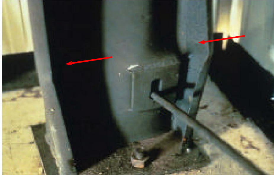
Fig. 2. 23 Falla por pandeo del patín en una columna.
