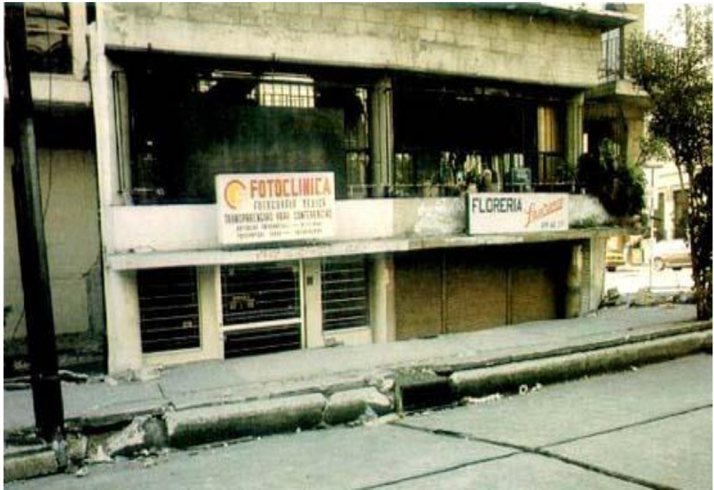
Fig. 2. 91 Asentamiento de una edificación
