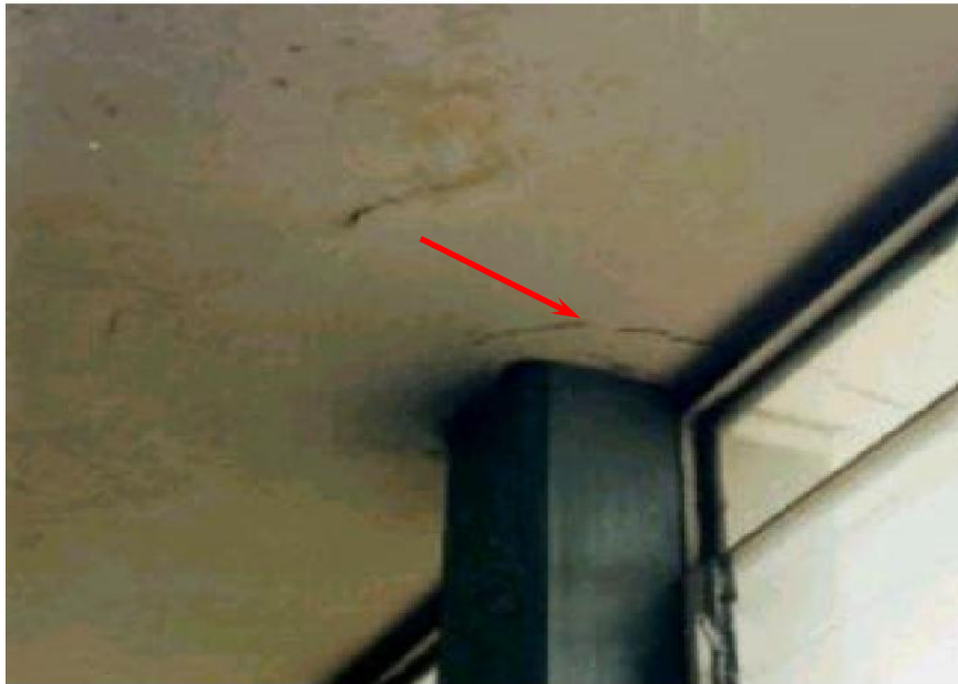
Fig. 2. 50 Grietas alrededor de una de las columnas en la que se apoya una losa plana ( http://catarina.udlap.mx/u_dl_a/tales/documentos/lic/murillo_j_cg/capitulo5.pdf ).
