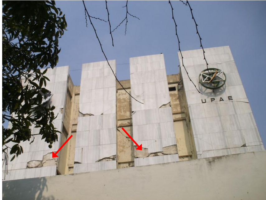
Fig. 4. 14 Fachada lateral del edificio de correos, en la que se observa el recubrimiento (aparentemente de mármol) que representa un peligro, ya que puede caer debido a su gran peso.
