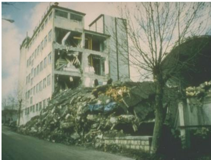
Fig. 2. 79 Colapso total de edificaciones ( http://www.ujaen.es/investiga/rnm217/efectos.htm ).
