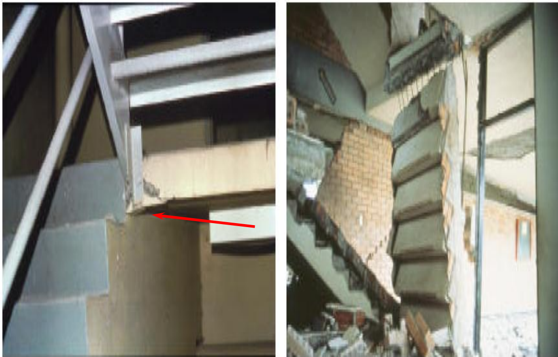
Fig. 2. 74 Grietas (izq.) y colapso (dcha.) en escaleras (Asociación Colombiana de Ingeniería Sísmica, 2003).
