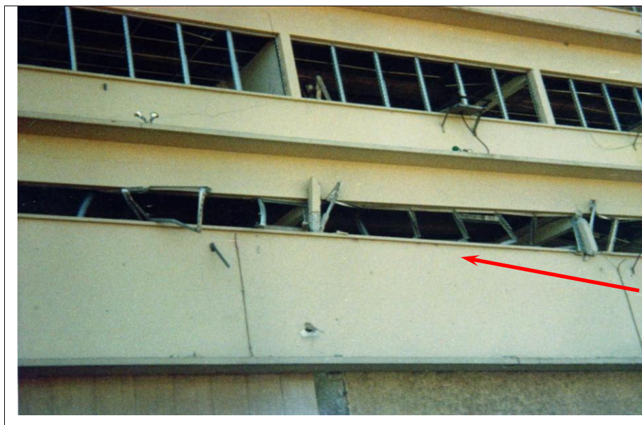
Fig. 2. 65 Efecto de columna corta en un sistema de marco de un edificio luego del sismo del 10 de octubre 1986 en nuestro país (Avalos, J. y otros, 1986).
