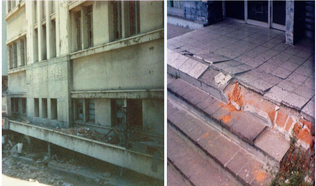
Fig. 2. 89 Asentamiento del edificio Dueñas ubicado en la capital de nuestro país (izquierda) y Piso deteriorado por emersión (derecha) (Avalos C., Juan J., 1987).
