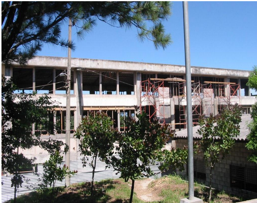
Fig. 4. 4 Imagen de la fachada del edificio de Ingeniería Industrial de la FIA-UES.
