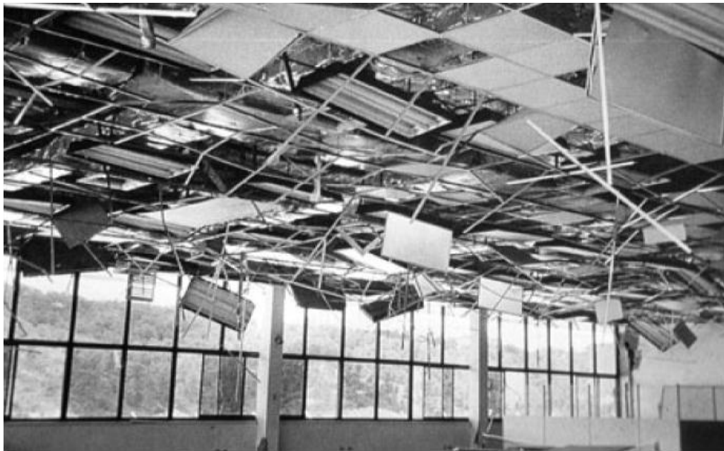
Fig. 2. 71 Daños en cielos falsos (Organización Panamericana de la Salud, 2004).
