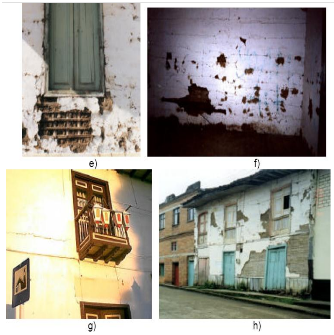
Fig. 2. 40 Ejemplos de tipos de falla en edificaciones de bahareque (Asociación Colombiana de Ingeniería Sísmica, 2003).
