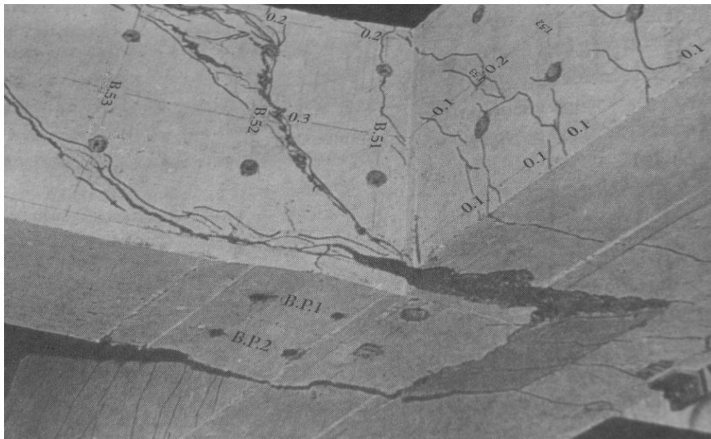
Fig. 2. 17 Falla ocasionada por la falta de soporte para la compresión diagonal en una unión viga secundaria-viga principal (Nilson, 2001).
