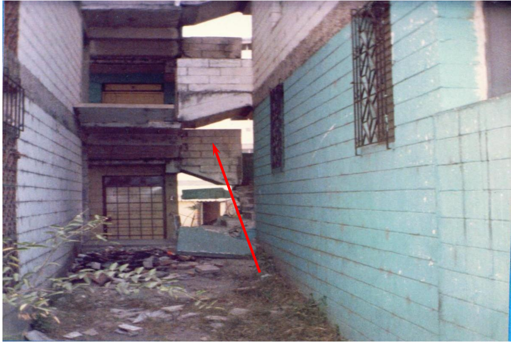
Fig. 2. 75 Colapso de gradas de una edificación durante el sismo de 1986 en nuestro país (Avalos C., Juan J., 1987).
