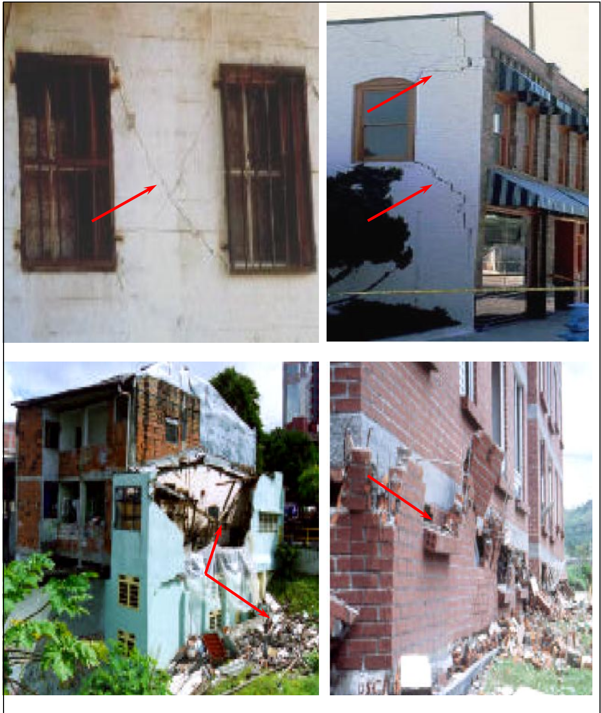
Fig. 2. 36 Falla por cortante (superior izquierda), falla por cortante y flexión (superior derecha) y falla por la combinación de cortante, flexión y compresión (inferiores) (Asociación Colombiana de Ingeniería Sísmica, 2003).
