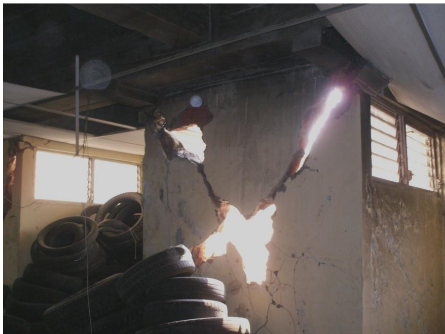
Fig. 4. 17 Pared colapsada, además se evidencia que el edificio aún sigue siendo utilizado como bodega (para guardar llantas).
