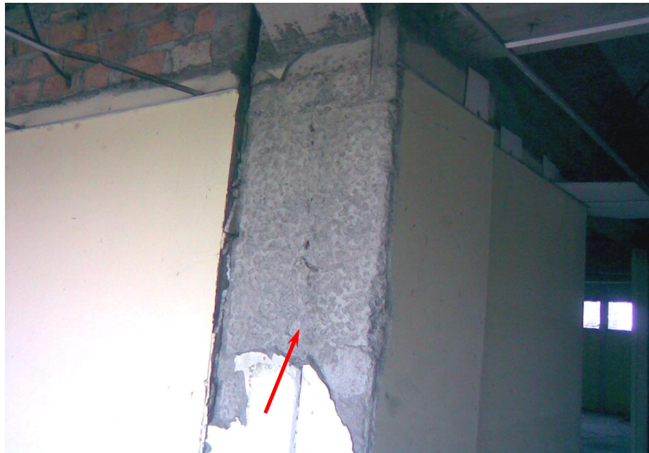
Fig. 2. 11 Daño leve por la pérdida del repello en una columna del ex edificio de Correos de El Salvador.
