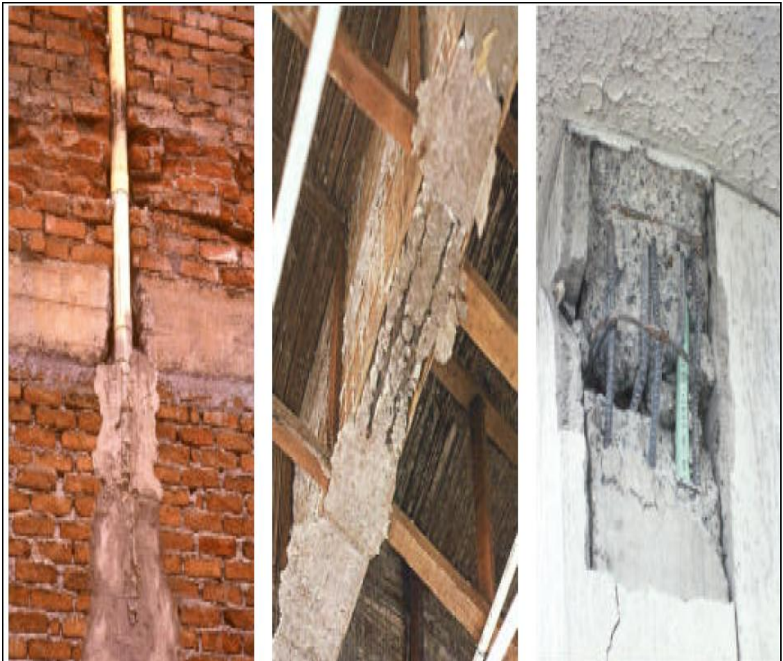
Fig. 2. 1 Ejemplos de mala calidad en la construcción, mal pegado de ladrillos y mala canalización de bajadas de aguas lluvias (izq.) y colado deficiente de elementos de concreto reforzado (centro y dcha.)
