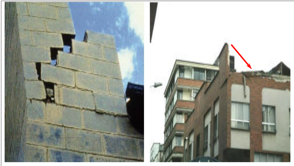
Fig. 2. 68 Desprendimiento de las piezas e inclinación apreciable del parapeto (izq.) y caída del parapeto (dcha.).
