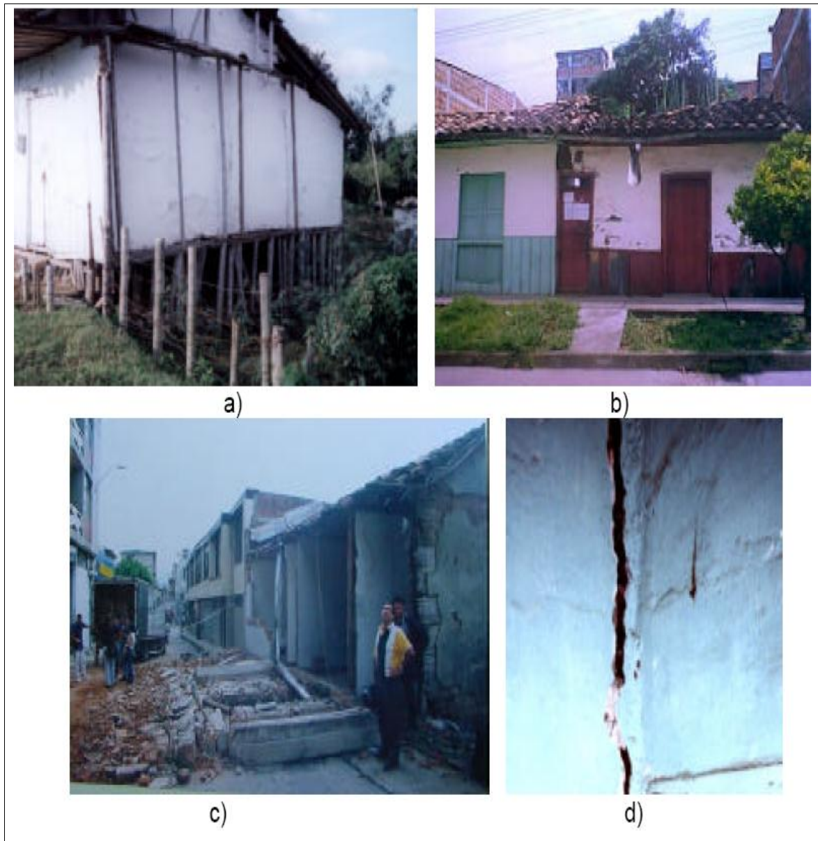
Fig. 2. 39 Ejemplos de tipos de falla en edificaciones de bahareque (Asociación Colombiana de Ingeniería Sísmica, 2003).
