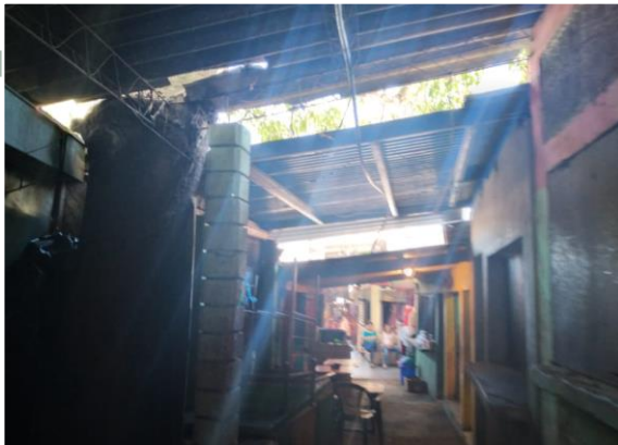
Aberturas en techo, poca iluminación y filtración de agua en época de lluvia.
