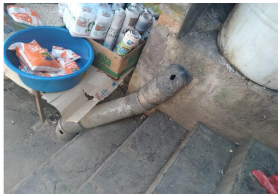
Tubería de un lavandero expuesta y dañada.
