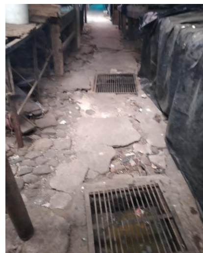
Aguas residuales estancadas.
