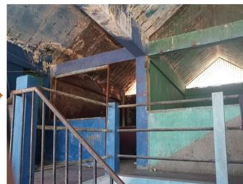
Fotografía 4: Corrosión en elementos metálicos. Fuente: Elaboración Propia.
