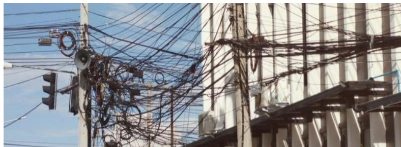
Ilustración 84: Ejemplo de saturación de cableado eléctrico
