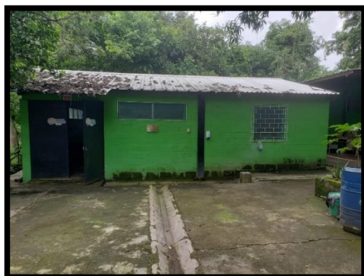
Fig. 7 planta de procesamiento ubicada en CIP NONUALCO
