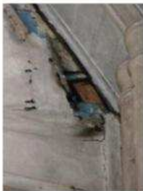
IMAGEN 073 DETALLE DAÑO EN CIELO FALSO
