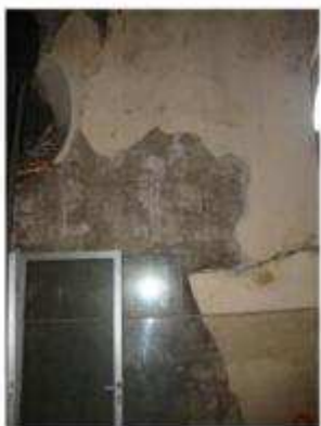
IMAGEN 053 PARED COLAPSADA, REPELLO DAÑADO
