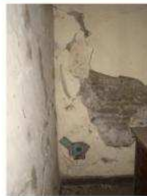
IMAGEN 079 COLAPSO DE REPELLO
