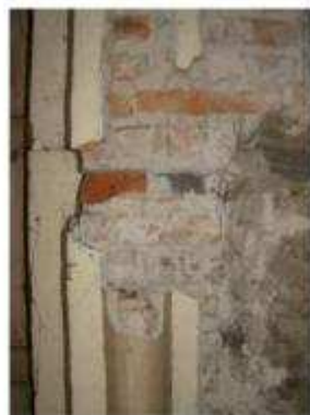
IMAGEN 082 DETALLE DAÑO EN PUERTA
