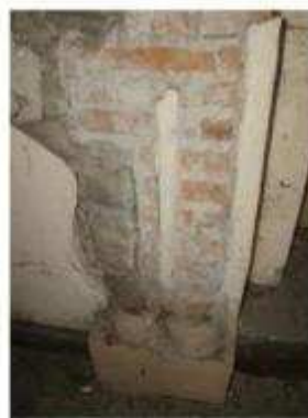
IMAGEN 083 MARCO DE PUERTA DAÑADO
