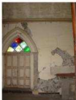
IMAGEN 089 PUERTA Y REPELLO DETERIORADO
