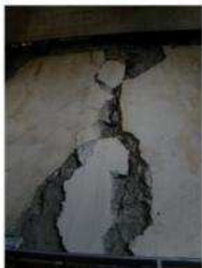
IMAGEN 057 DAÑO ESTRUCTURAL EN MURO
