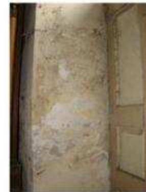
IMAGEN 100 DAÑO POR HUMEDAD
