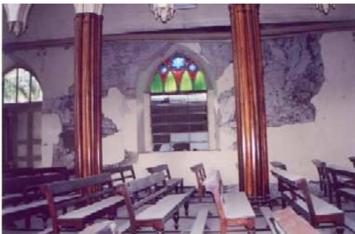
Imagen 55 Daños causados por el terremoto de 2001, Fotografía: UCA
