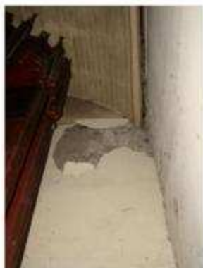
IMAGEN 081 DETALLE DAÑO EN CIELO FALSO
