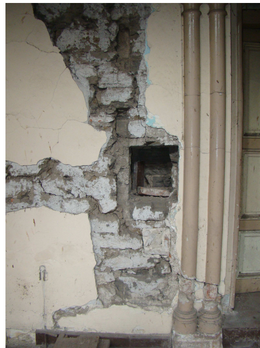
Imagen 54. Una de las paredes de la nave principal dañada gravemente por el terremoto de enero de 2001 Fotografía: Carlo Morán
