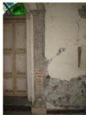
IMAGEN 086 DAÑO EN MARCO DE PUERTA
