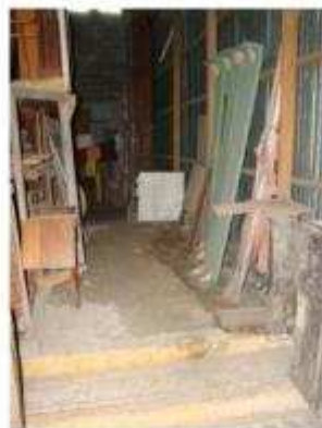
IMAGEN 050 PISO Y PARED COLAPSADOS
