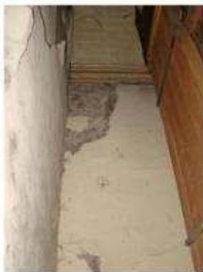
IMAGEN 078 DAÑO EN UNION ENTRE PAREDES
