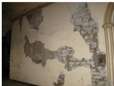
Imagen 45. Muros dañados por terremoto de enero de 2001 Fotografía: Carlo Moran
