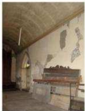
IMAGEN 093 PERSPECTIVA, PARED DAÑADA
