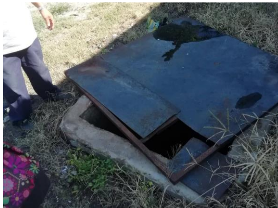
Ilustración 59 Balsa de recibo de líquidos lixiviados
