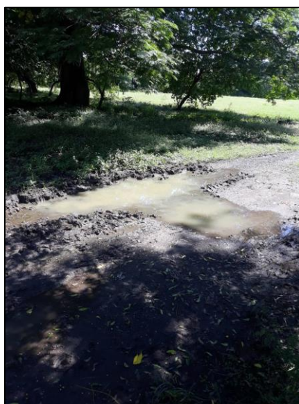
Figura 1.1 Problema típico de empozamiento de Agua en caminos rurales durante temporada de invierno
