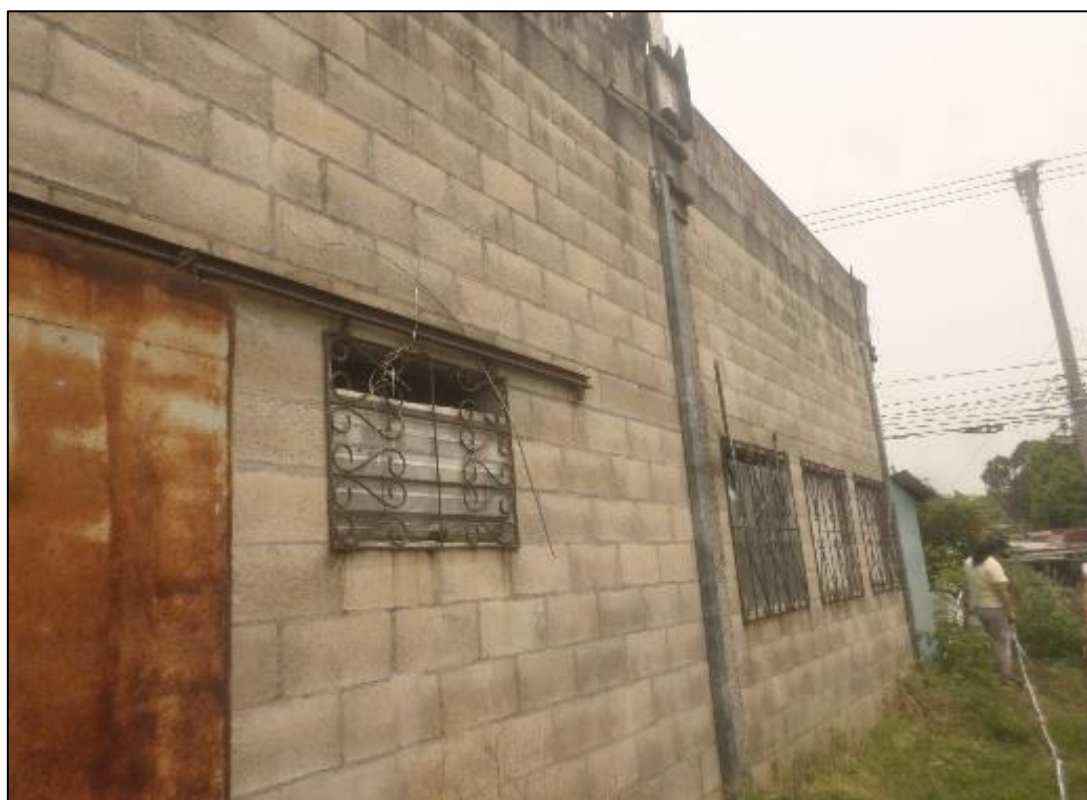
Figura 4-11 Condición actual de fachada oriente. Fuente: Elaboración propia
