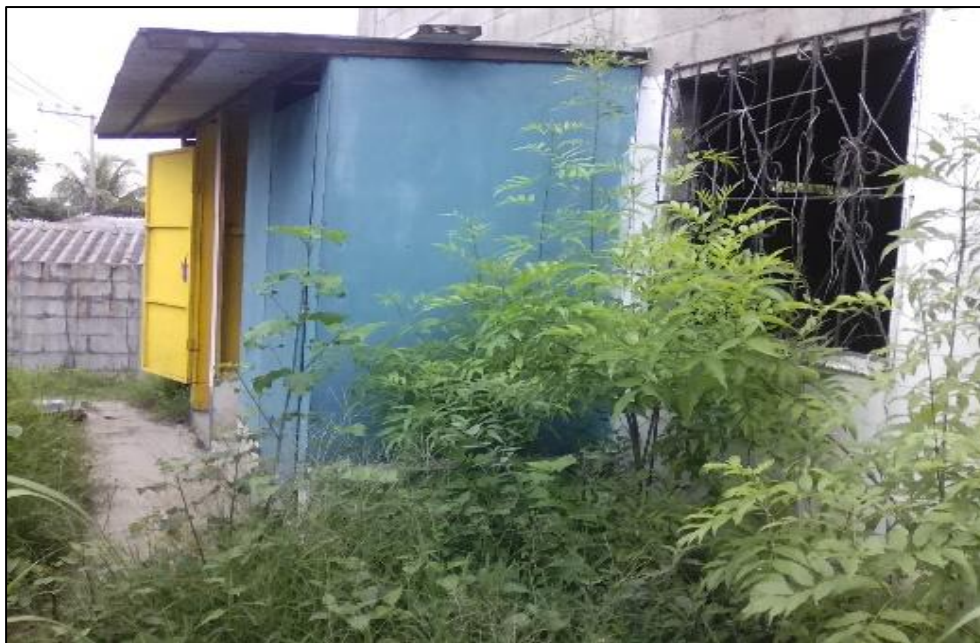
Figura 4-14 Módulo sanitario ubicado al exterior de edificación. Fuente: Elaboración propia
