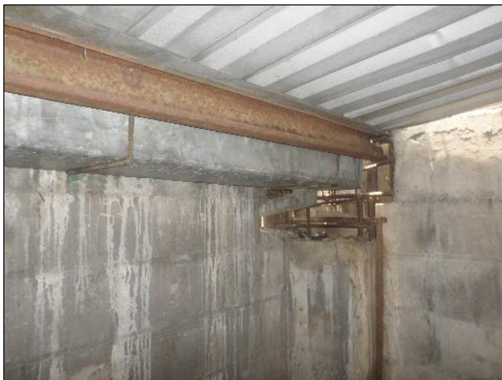
Figura 4-13 Condiciones actuales en paredes y falta de botaguas en techo. Fuente: Elaboración propia
