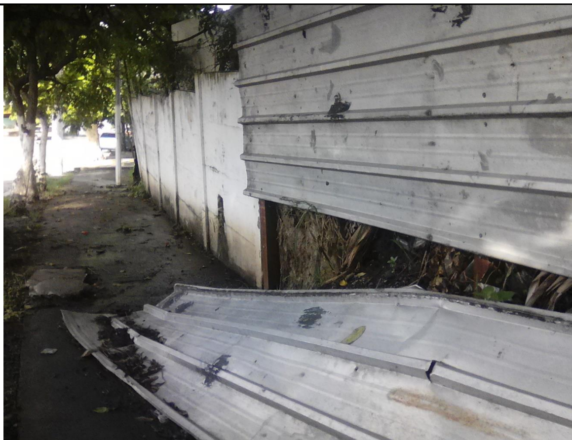
VISTA DEL TAPIAL PREFABRICADO LINDERO NORTE, QUE HA FALLADO EN ALGUNAS ZONAS.
