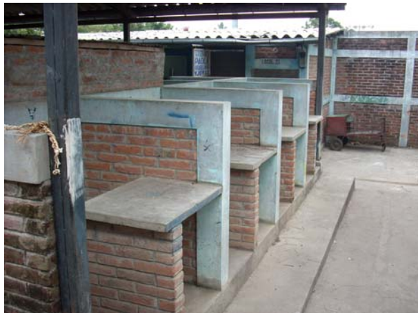
Puestos sin uso (Foto-MO7)
