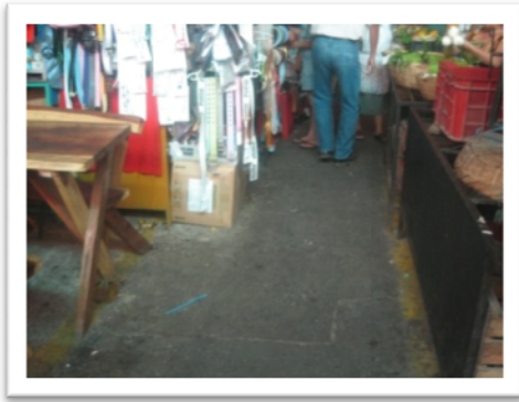
Piso interno del mercado deteriorado
