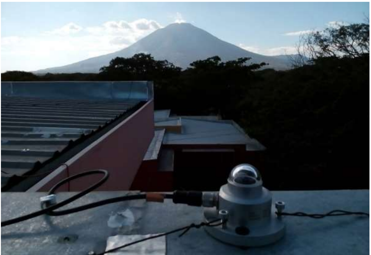
Figura 6-16 Instalación del piranómetro.
