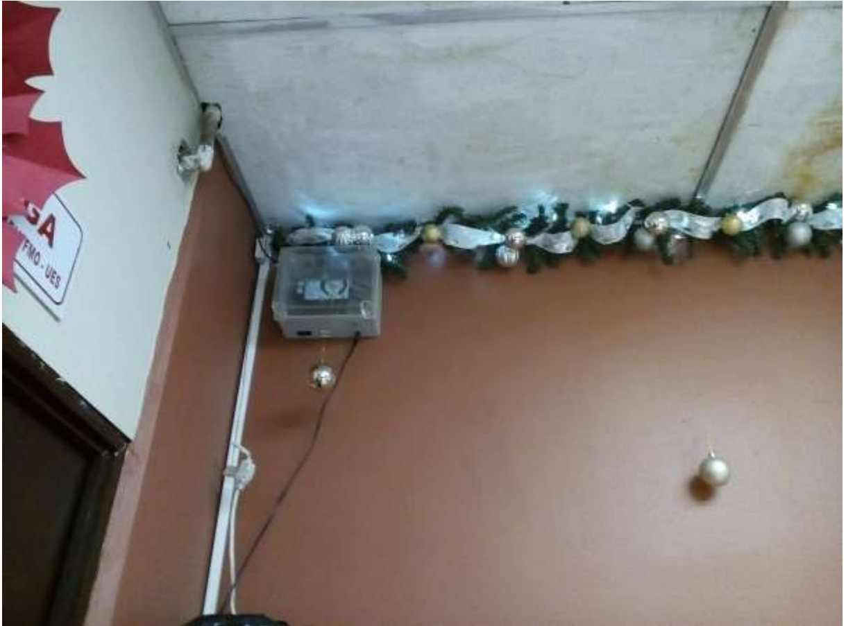
Figura 6-17 Medidor M3, instalado en la segunda planta de la biblioteca, solón de Administración.
