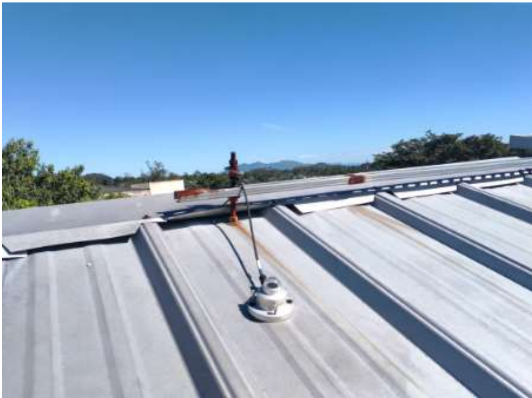
Figura 6-5 Instalación del piranómetro.
