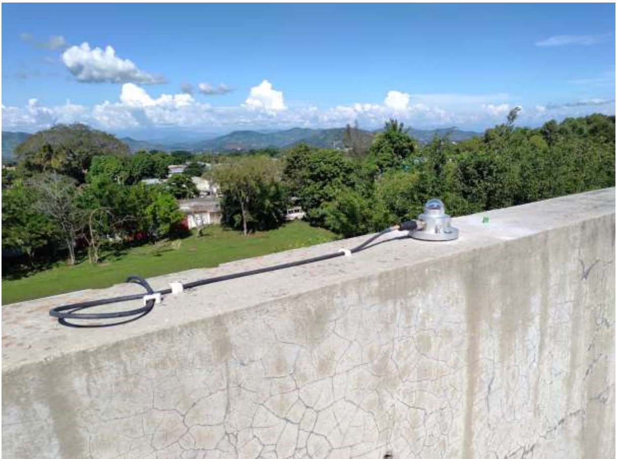
Figura 6-10 Instalación del piranómetro.
