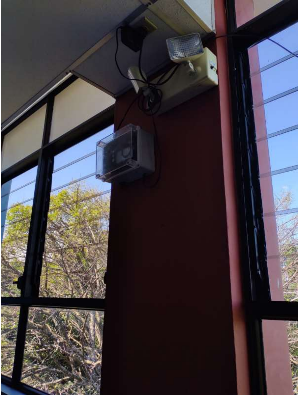
Figura 6-11 Medidor M2, instalado en la sala de reuniones del decanato.
