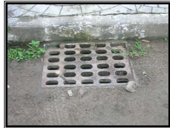
Tragante de agua lluvia con parrilla de hierro fundido
