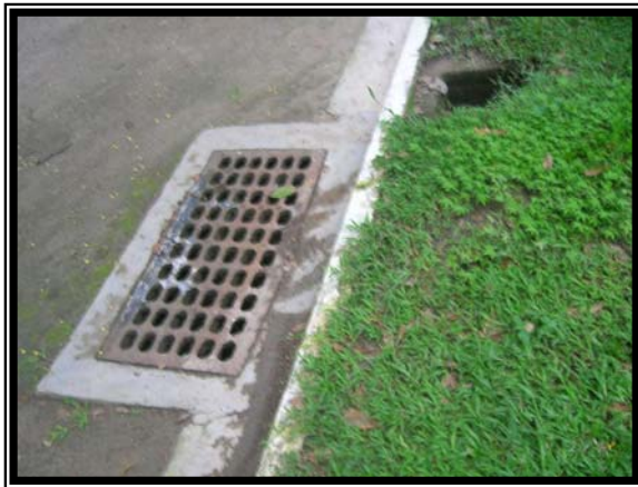
Tragante de agua lluvia con parrilla de hierro fundido
