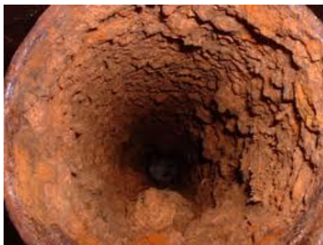
Figura 1.23. Tubería de hierro oxidada por la corrosión del agua. Fuente: (Delrey, 2019).
