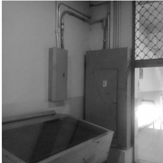
Figura 4.1 Punto de acometida eléctrica principal del edificio.
