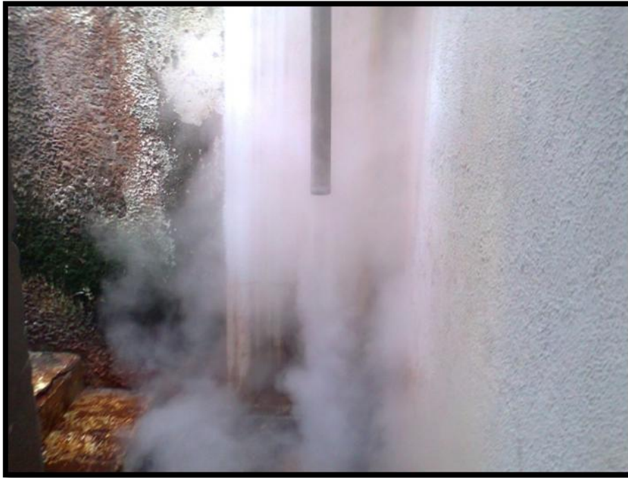
Figura 3. 9 Pérdida de Vapor Cercana a la Caldera en el HNM.
